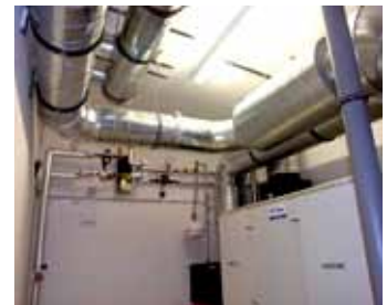
Lüftungszentrale für 15 Wohnungen
