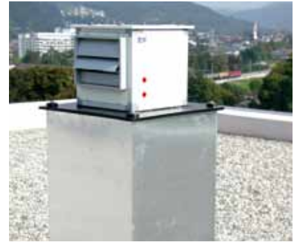
Abluftventilator für einen Steigstrang als Zentralgerät auf dem Dach mit Schalldämpfer im Sockel
