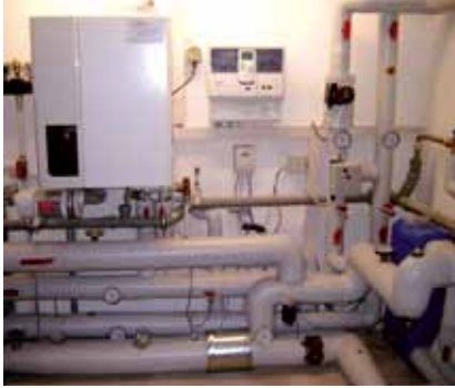
Gas-Brennwert-Anlage für ein energieeffizientes Mehrfamilienhaus mit 1.000 m 2 Wohnfläche
