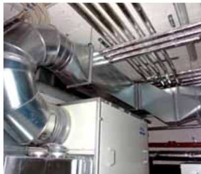
Lüftungszentrale für zehn Wohneinheiten mit hochwertigem Schalldämpfer für die Zuluft
