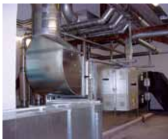
Zentrale der Zu-/Abluftanlage
