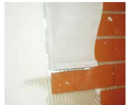
Wärmedämmverbundsystem getarnt als historisches Backsteinmauerwerk
