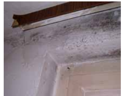
Schimmelpilzbildung hinter einem Vorhang aufgrund zu niedriger Oberflächentemperaturen
