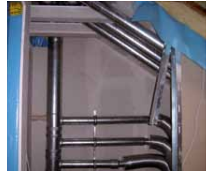
Verteilung: direkter Anschluss der Schalldämpfer an die Brandschutzklappen
