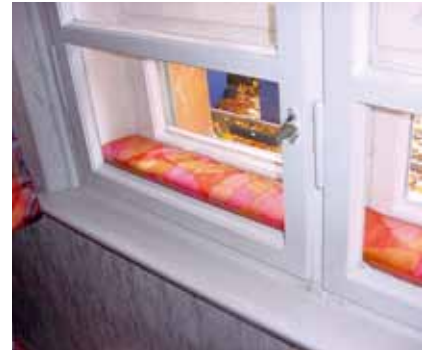
Mieterselbsthilfe gegen zugige Fenster im Winter
