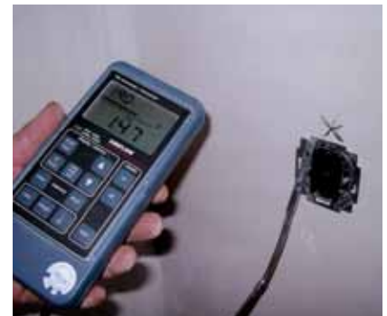
Gebäudetechnik: Lecks an Elektrolehrröhren und -Unterputzdosen sowie Durchbrüchen von Leitungen
