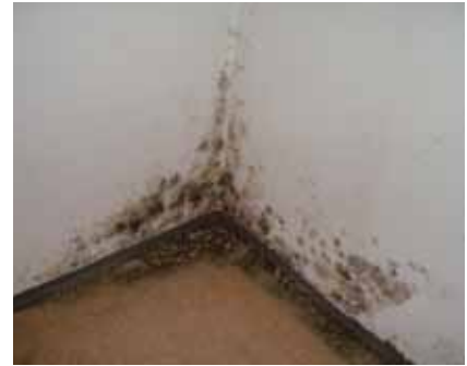
Schimmel in einem Gebäude mit 6 cm Dämmung in einer Außenecke hinter einem Schrank
