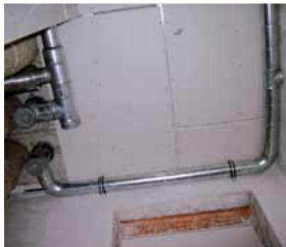
Zuluftleitung im Flur vor der Verkleidung mit Gipskarton
