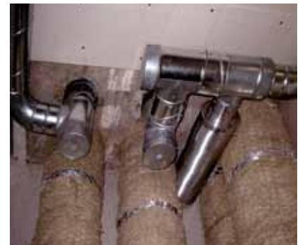
Steigstrang mit Abzweig von Zu- und Abluftleitung für eine Wohnung
