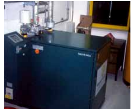
Günstig für den Anlagenaufwand: Einsatz von Kraft-Wärme-Kopplung
