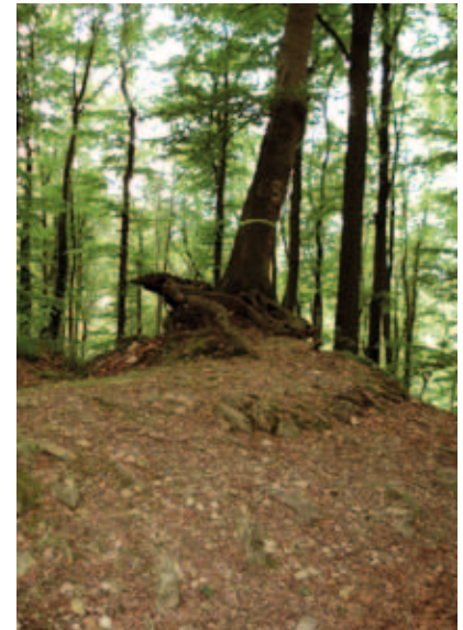
Abb. 2: Mauerkrone des Bergfriedes mit Baumbewuchs
