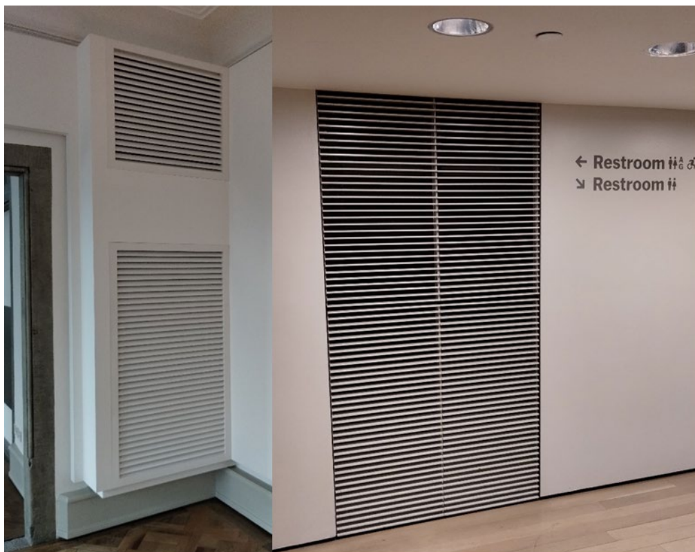
Abb. 11: Beispielbilder von großflächigen, druckverlustarmen Zuluft- und Abluftelementen im Raum Cavazzen Lindau (li), MoMA New York (re)
