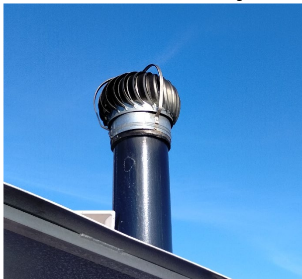
Abb. 37: windangetriebener Ventilator als Kaminhaube
