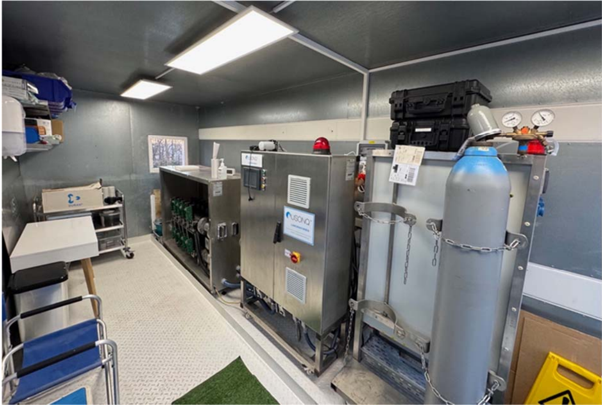
Abbildung 4: Blick in den 20' Seecontainer mit eingebauter Testanlage USO4 und Sauerstoffversorgung.
