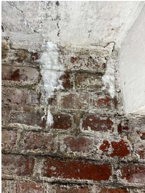
Abbildung 18: Salzbefund im Kellerraum der Firma Gehre
