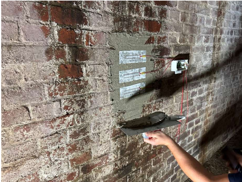
Abb. 13: Anbringen der Sensoren durch Herrn Gehre in seinem Firmengebäude
