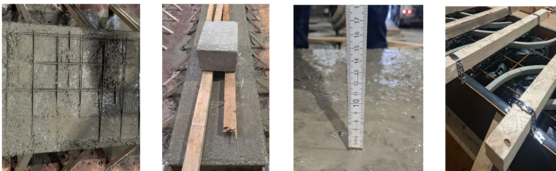
Abbildung 24: Aufschwimmen der Hohlkörper XS-A 30/130 Normalbeton (links); Beschwerung zur Herstellung der planmäßigen Lage der Hohlkörper und Betondeckung über Hohlkörper (mittig) und Konstruktion für die Probekörper XS-A30-R und XS-A130-R, um ein Aufschwimmen der Hohlkörper zu verhindern.
