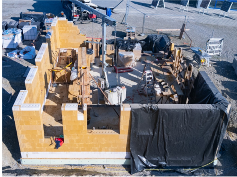
Abbildung 102: Witterungsschutz während der Bauausführung. Die Wände sind vollflächig vor Niederschlag zu schützen.
