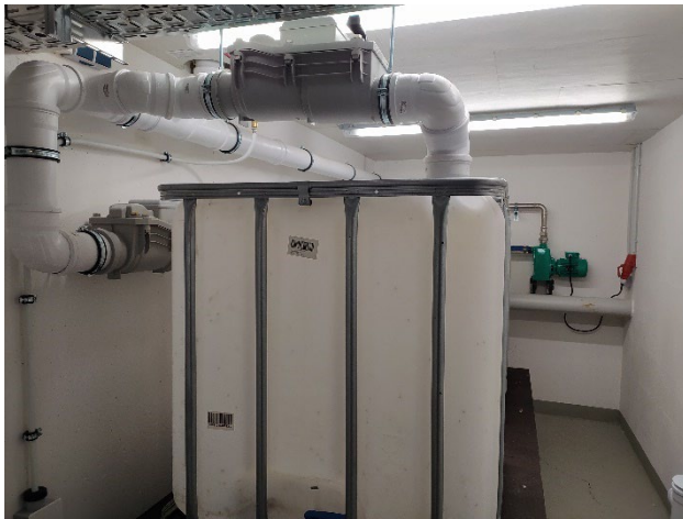
Abbildung 4: Sammelbehälter für Grauwasser
