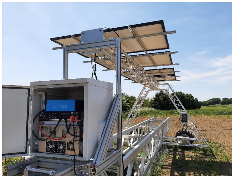
Abbildung 18: Schaltschrank an Pivotsäule
