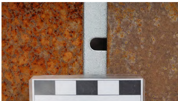
Abb. 11: Platte S5_AGS3 (links) und S5_AGS4 (rechts): unregelmäßig weitergehende Korrosion trotz Überzug.
