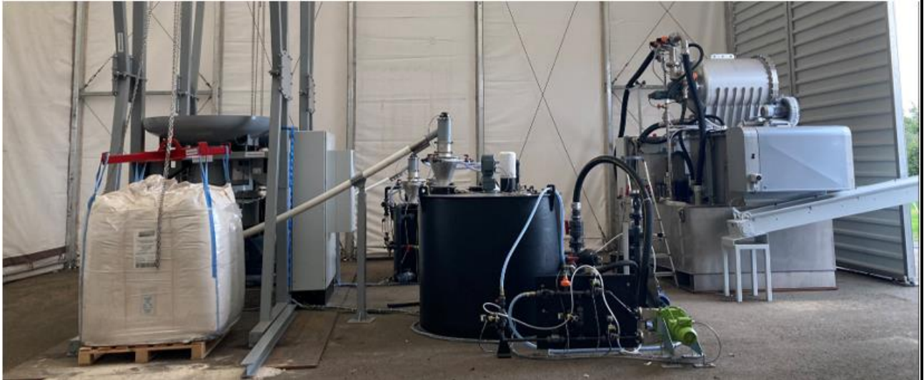
Pilotanlage mit Dosiertechnik © A. Klinkert 2024
