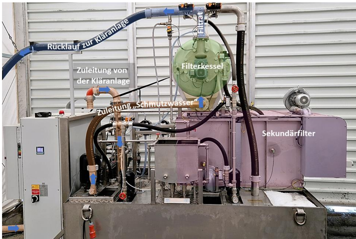
Abbildung 8: Filteranlage (Foto A. Klinkert, 2024)
