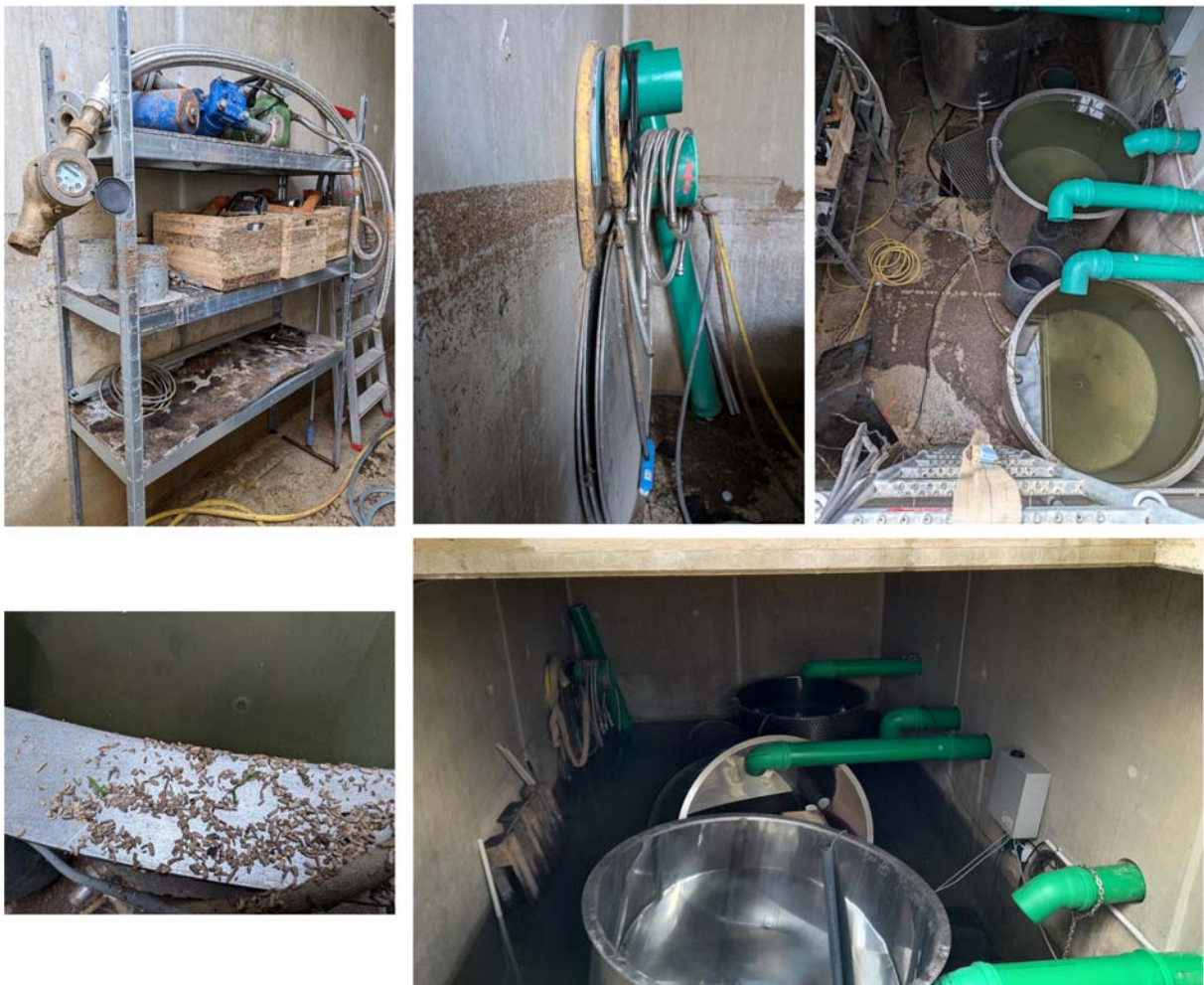
Abbildung 38: Fotos des Probenahmekellers nach einer Überflutung. Der Keller war bis etwa 1,50 m Höhe komplett mit Wasser gefüllt.
