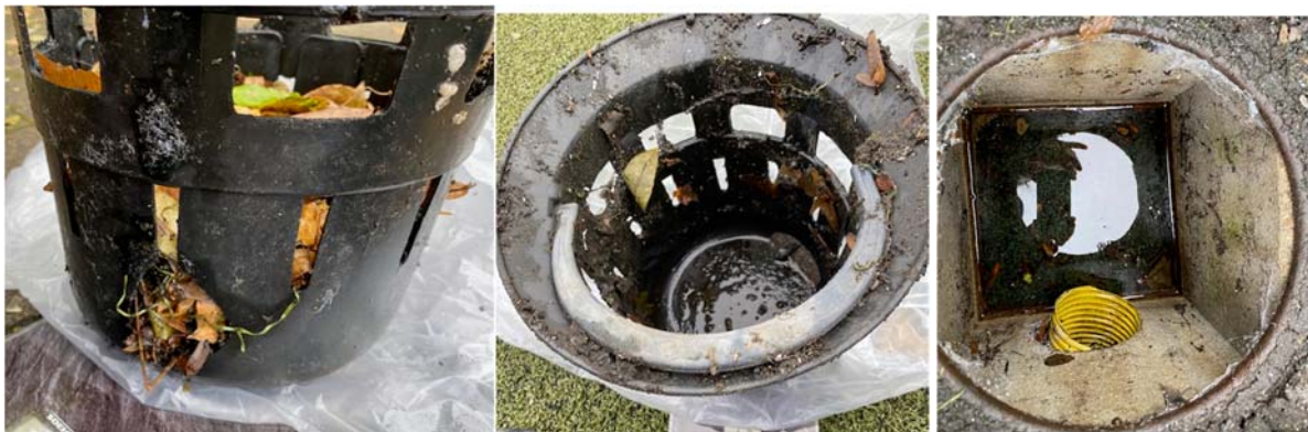
Abbildung 10: Fotos des Auffangkorbes und des Gullys vom Kunstrasenplatz NRW 3
