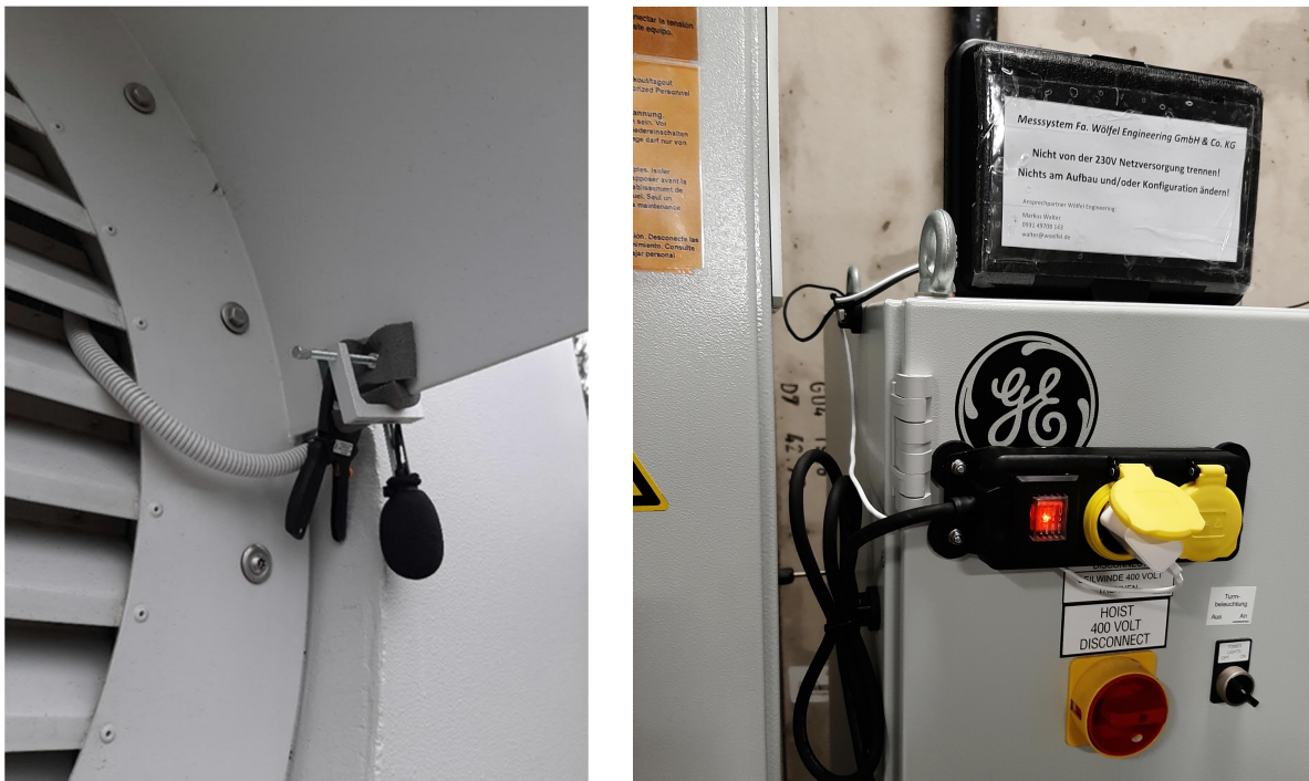
Abbildung 2: Installation des Noisy.Blade-Systems an einer WEA. Das Mikrofon mit Windschutz (links) wurde am Vordach des Lüftungsauges außen am Turm festgeklemmt. Die Messtechnik (schwarzer Kasten rechts) ist im Turm in der Nähe des Lüftungsauges auf einem Schaltschrank platziert.
