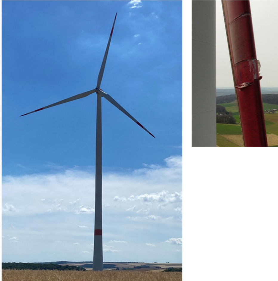
Abbildung 10: Mit Noisy.Blade detektierter Schaden an einem Rotorblatt (Folienablösung).
