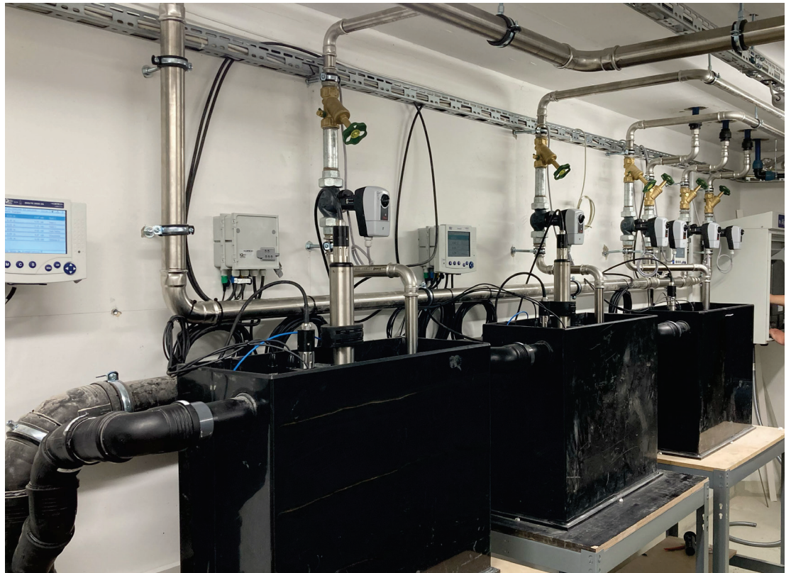
Die Steuerungszentrale der Teichtechnik Hier werden die Daten erhoben, ausgewertet und daraufhin Steuerungsmaßnahmen eingeleitet Quelle: Xylem / N. Kaltwasser
