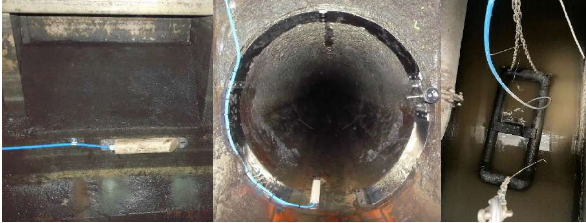
Abbildung 3.2: Exemplarischer Einbau der Sonden (links: horizontal eingebaute PKM Sonde an der Entlastung SKU 0133, mitte: auf der Sohle eingebaute POA Sonde am RKB 0337, rechts: Katamaran in der Kläranlage) ©NIVUS
