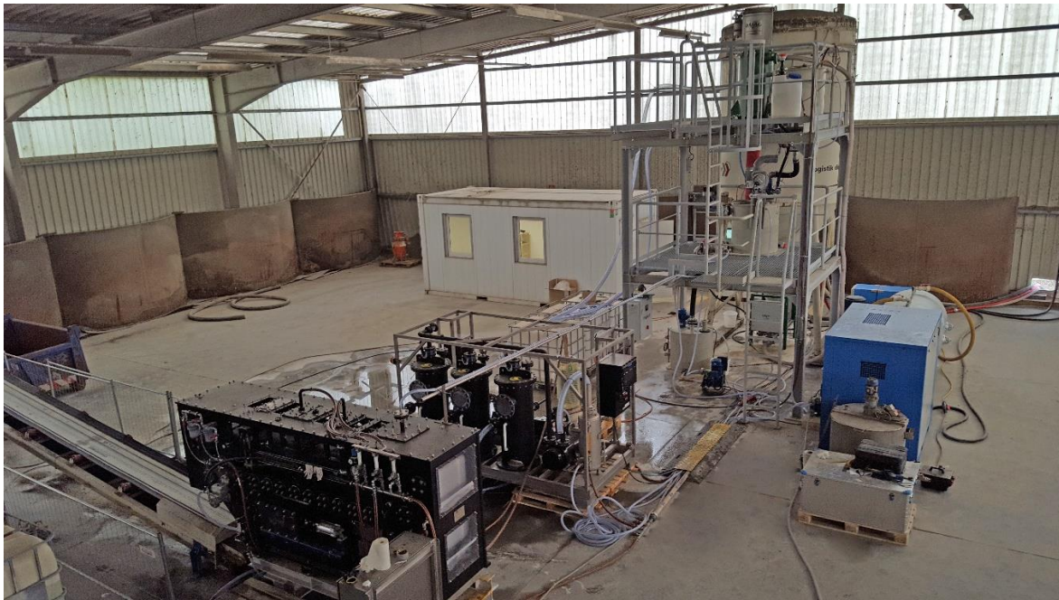
Bild 6: Anmischsystem und Bandfilter der Versuchsanlage
