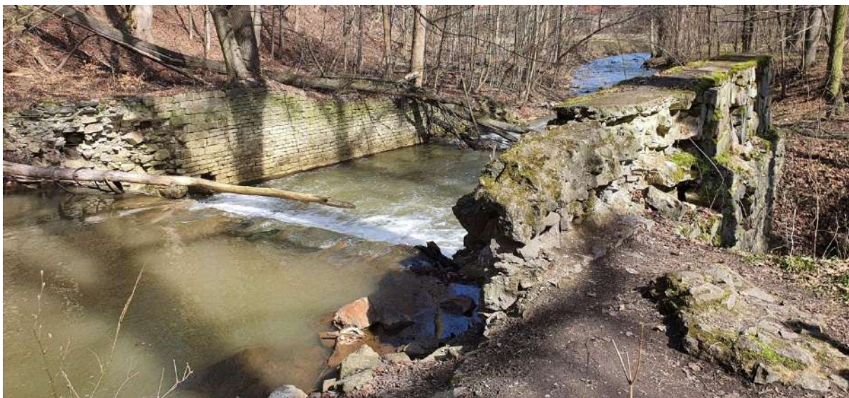
Abb. 63: Schäden an der Großen Wehranlage (PELC-53), Fotografie, Tomasz Kowalczyk, 2022.
