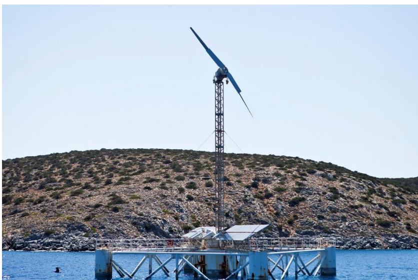
Abbildung 1: Entsalzungsanlage auf den Kykladen, Griechenland (Foto: iStock/Yoeml)
