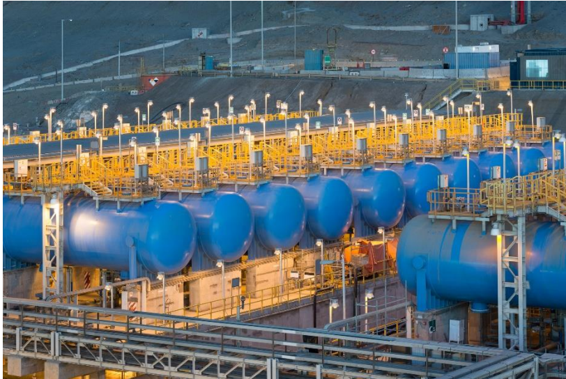
Abbildung 1: Energieintensive Entsalzungsanlage (Foto: iStock/tifonimages)
