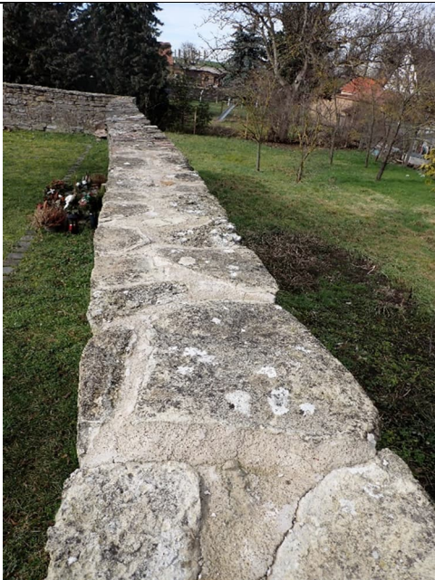
Abbildung 100: Teil der Musterfläche der Kirchhofmauer: Im Bildvordergrund sind einige Fugenflankenablösungen erkennbar, ansonsten ist die Aufmauerung ungeschädigt.
