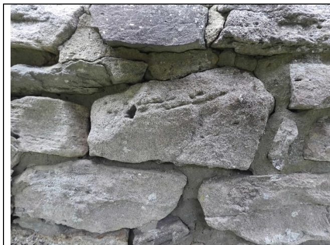
Abbildung 17: Detail der Außenseite des Turmstumpfes mit Rissen in den Fugenflankenbereichen und starker Rückwitterung
