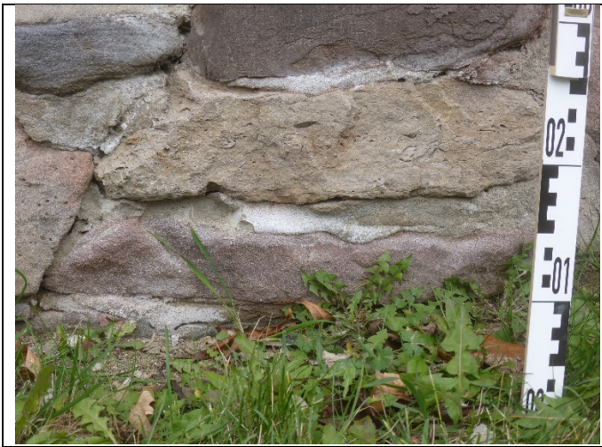
Abbildung 12: Probenahmestelle WST/B/06; Verfugmörtel mit weißer Salzkruste
