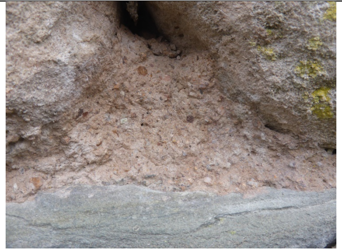
Abbildung 15: Probenahmestelle WST/B/08.2; der rötliche Reparaturmörtel liegt unter dem Mörtel 08.1M
