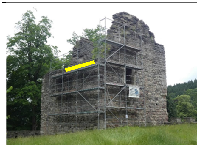
Abbildung 80: Turmstumpf der Burgruine Winterstein: Eingerüsteter Bereich vor Beginn des Anlegens der Musterflächen. Die Einarüstung wurde durch den Eigentümer und Projektpartner, die Verwaltungsgemeinschaft Waltershausen, veranlasst.
