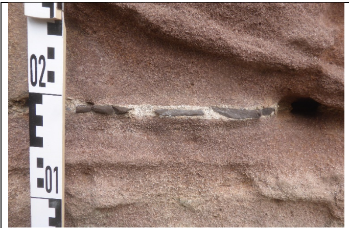
Abbildung 9: Probenahmestelle WST/B/03 im Bereich einer Setzfuge, erkennbar sind die Versetzhilfen
