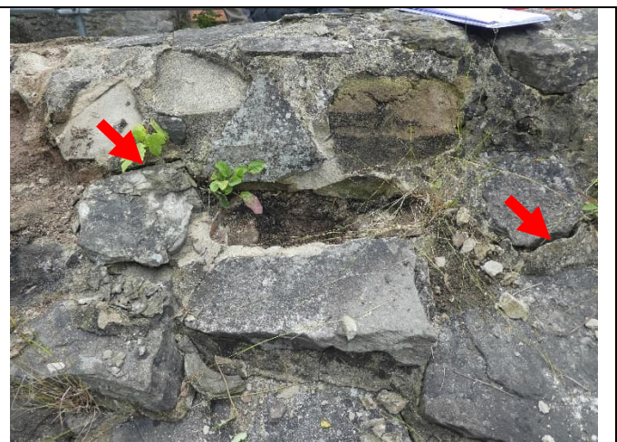
Abbildung 18: Detail der Mauerkrone: Etwa in Mauermitte durchzieht ein fassadenparalleler Riss das Mauerwerk (Pfeil)
