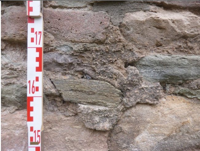
Abbildung 14: Probenahmestelle WST/B/08.1, älterer Reparaturmörtel
