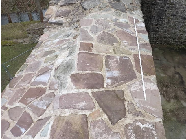
Abbildung 98: Teilbereich der Mauerkrone des Turmstumpfes der Burgruine Winterstein: Auf den Oberflächen sind lediglich leichte Kalkaussinterungen erkennbar.
