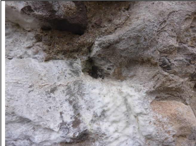
Abbildung 16: Probenahmestelle WST/B/09 mit der weißen oberflächigen Aussinterung auf dem Mauerwerk
