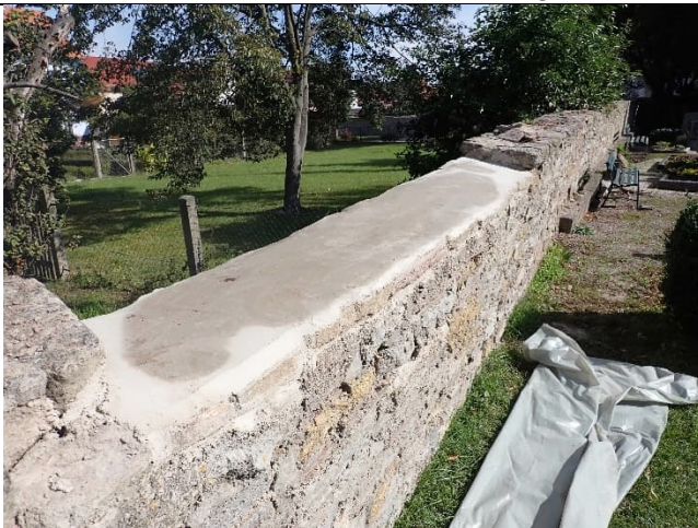
Abbildung 93: Unterbau aus sulfatbeständigem Mörtel für den Auftrag der flächigen Abdichtungs- und Entkopplungsschicht
