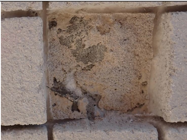
Abbildung 77: Bruchbild S2 im Sandsteinmauerwerk-Demonstrator
