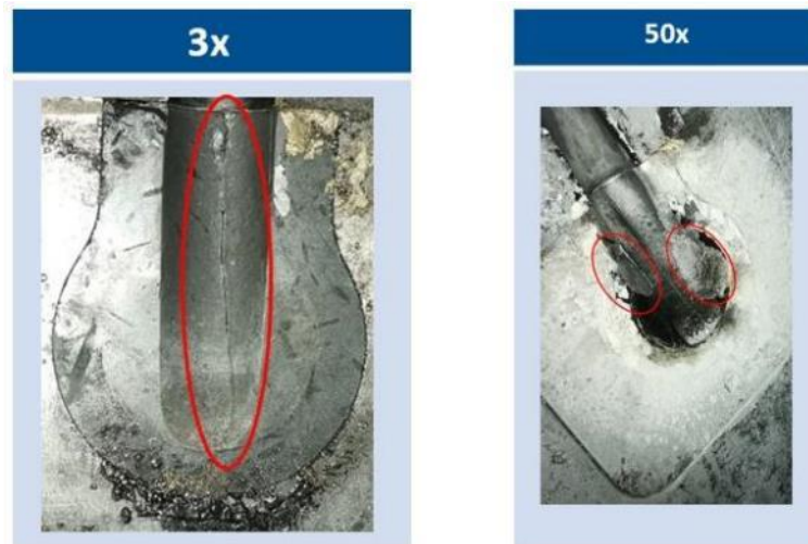
Abbildung 36: Beschädigungen trotz Verklebung (links) und Hinterschnittpassung (rechts)
