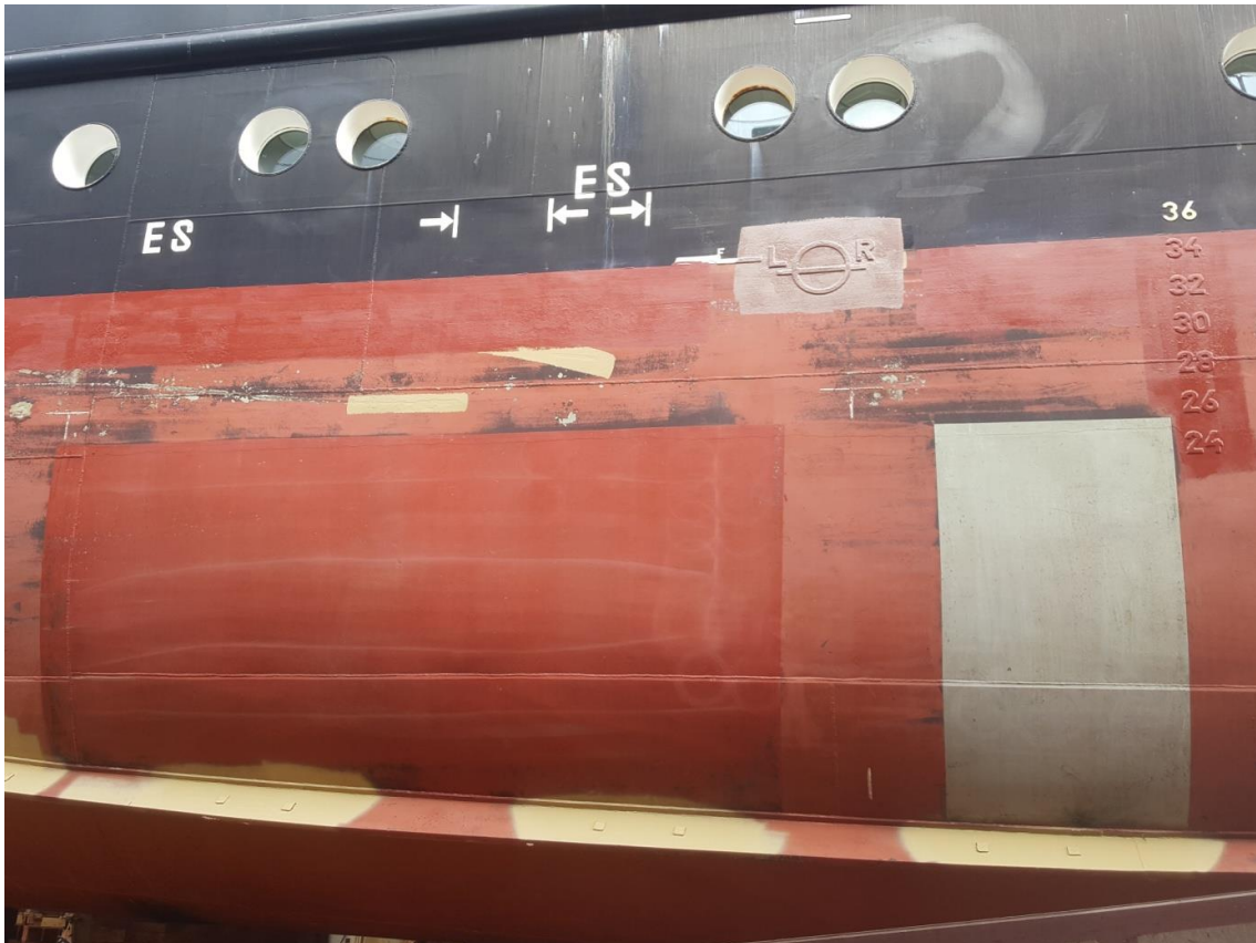
Abb. 26: Testbeschichtungen auf der „WEGA“ Juli 2019 nach vollständiger HD-Reinigung im Dock, links Jotun, rechts Momentive/Wohlert
