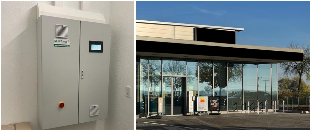
Abbildung 9: links: Schaltschrank zum eingebauten RLT-Gerät im Muster-Supermarkt, rechts: Muster-Supermarkt in Böhl-Iggelheim
