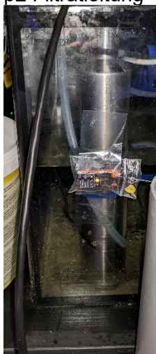
Nitratsonde Zulauf (an Control- ler sc100) und Wassersensor („Was_zu“ mit gelber LED)
