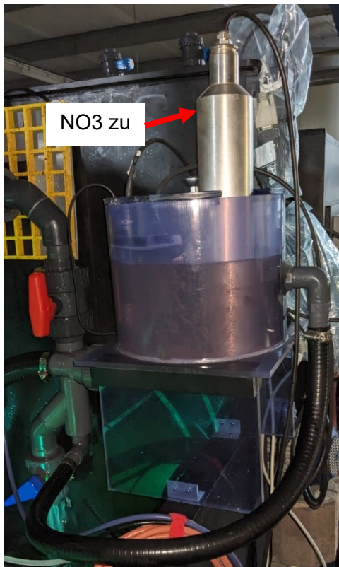
Abb. 32: Li.: Zulaufbecken für Sensoren im Zulauf (mit Nitratsensor NO3 zu, s. Abb. 34)
