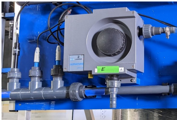
Trübungsmessung Ultraturb Plus sc, (links davon O 2 , pH und ORP Messeinrichtung)
