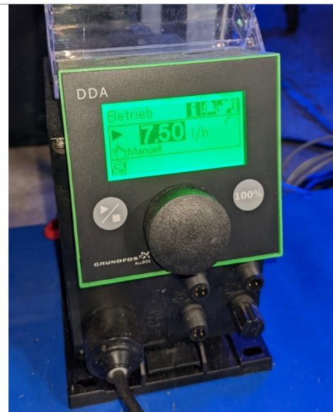
Abb. 18: Deni-Pumpe (Grundfos DDA, s. Tab. 9)
