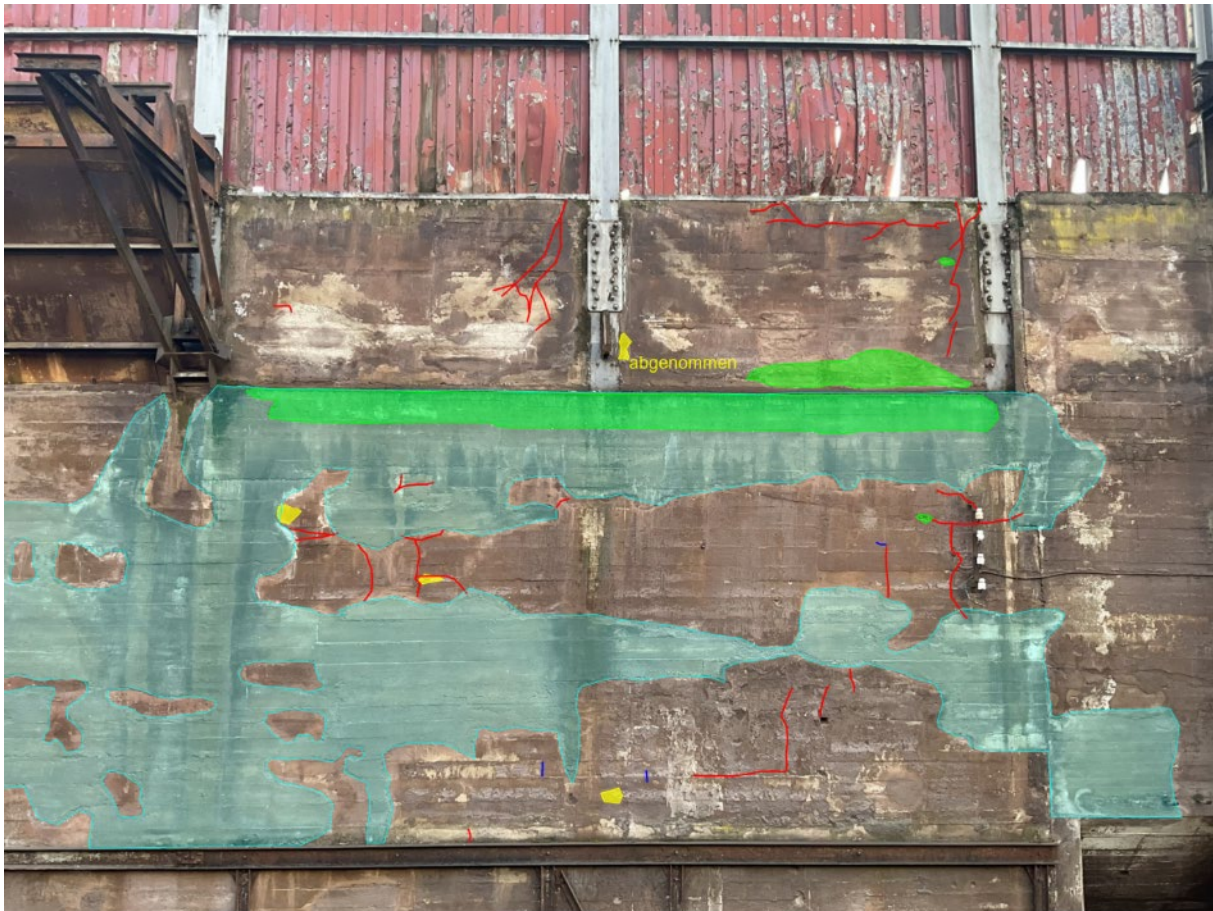
Abb. 52: Zustandskartierung eines Teilbereichs des Rohstoffbunkers (Dunkelblaue Linie: Offenliegende Bewehrung; rote Linie: Riss; hellblau: Instandsetzung; hellgrün: Kiesnest; gelb: Hohllage).
