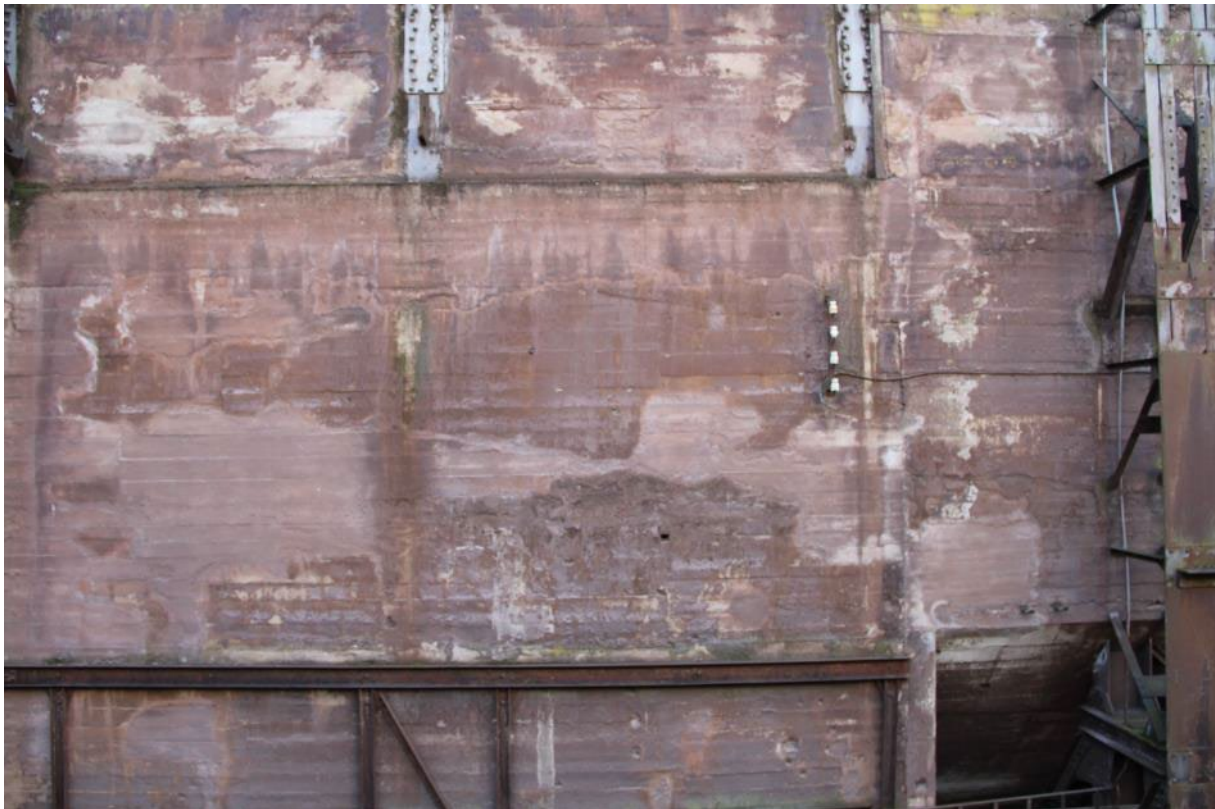
Abb. 51: Deutlich ablesbare Instandsetzungsbereiche mit Nachstellung der originalen Schalbrettstruktur und dem insgesamt heterogenen Erscheinungsbild.
