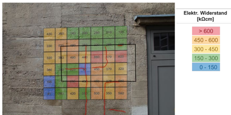
Abb. 26: Messergebnisse des elektrischen Widerstands mit der Wenner-Sonde. Die roten Linien kennzeichnen Risse. Der instandgesetzte Bereich ist schwarz umrandet.
