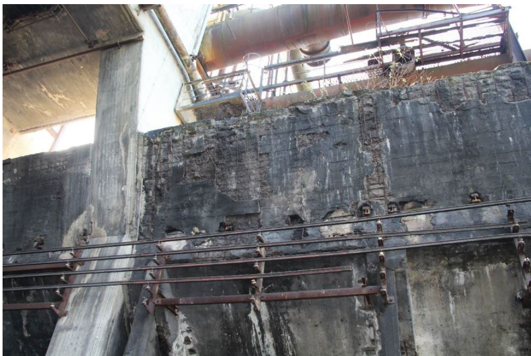
Abb. 55: An den noch nicht instandgesetzten Flächen des Kohlenbunkers ist die Schädigung der Betonoberfläche weit fortgeschritten.
