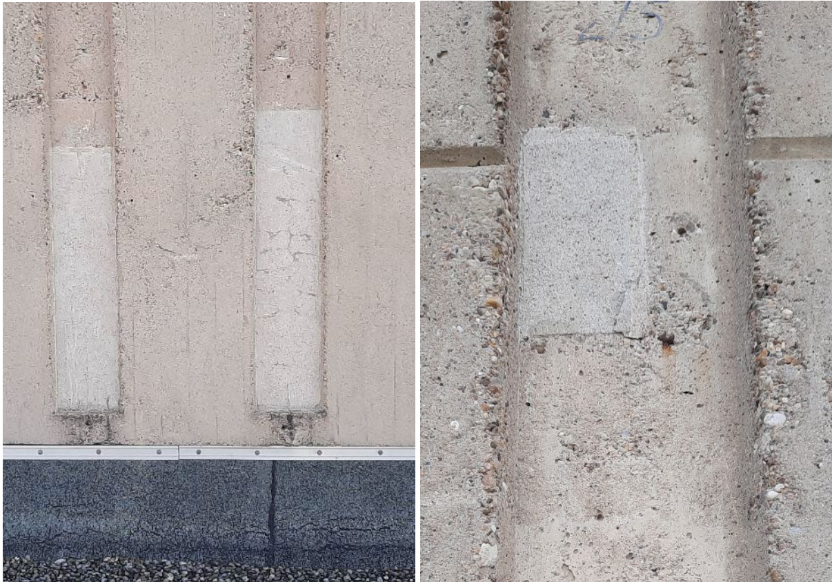
Abb. 58: Links: Kakeleerisse im Reparaturbeton, Rechts: kleine Abplatzung in Bestands- und Reparaturbeton
