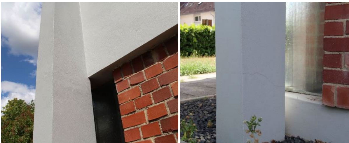
Abb. 10: Links: waagrechte Rissbildung im Anschlussbereich der Säule auf Höhe des Übergangs Mauerwerk zu Betonfassade. Rechts: Waagrechte, zum Teil umlaufende Rissbildung an einer Säule der Ostfassade.
