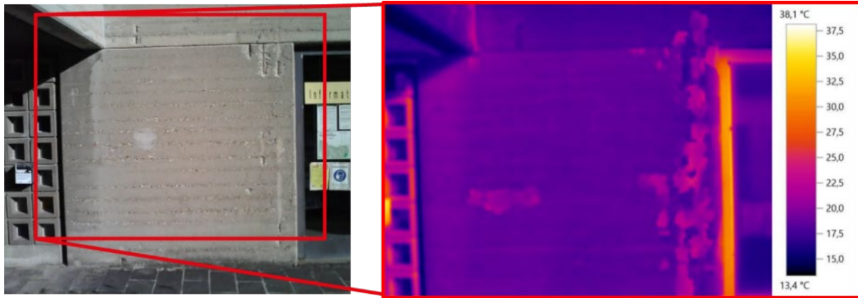
Abb. 31: Links: Foto des Fassadenabschnitts. Rechts: Im noch nicht instandgesetzten Teil des Bauwerks zeigt das Wärmebild bei direkter Sonneneinstrahlung neben den visuell erkennbaren Abplatzungen eine Vielzahl von beginnenden Ablösungen.
