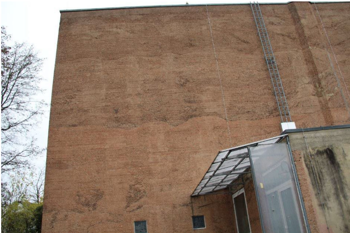
Abb. 39: Wellenförmige Schüttnlinien und dunkle Kiesnester im Ziegelsplittbeton
