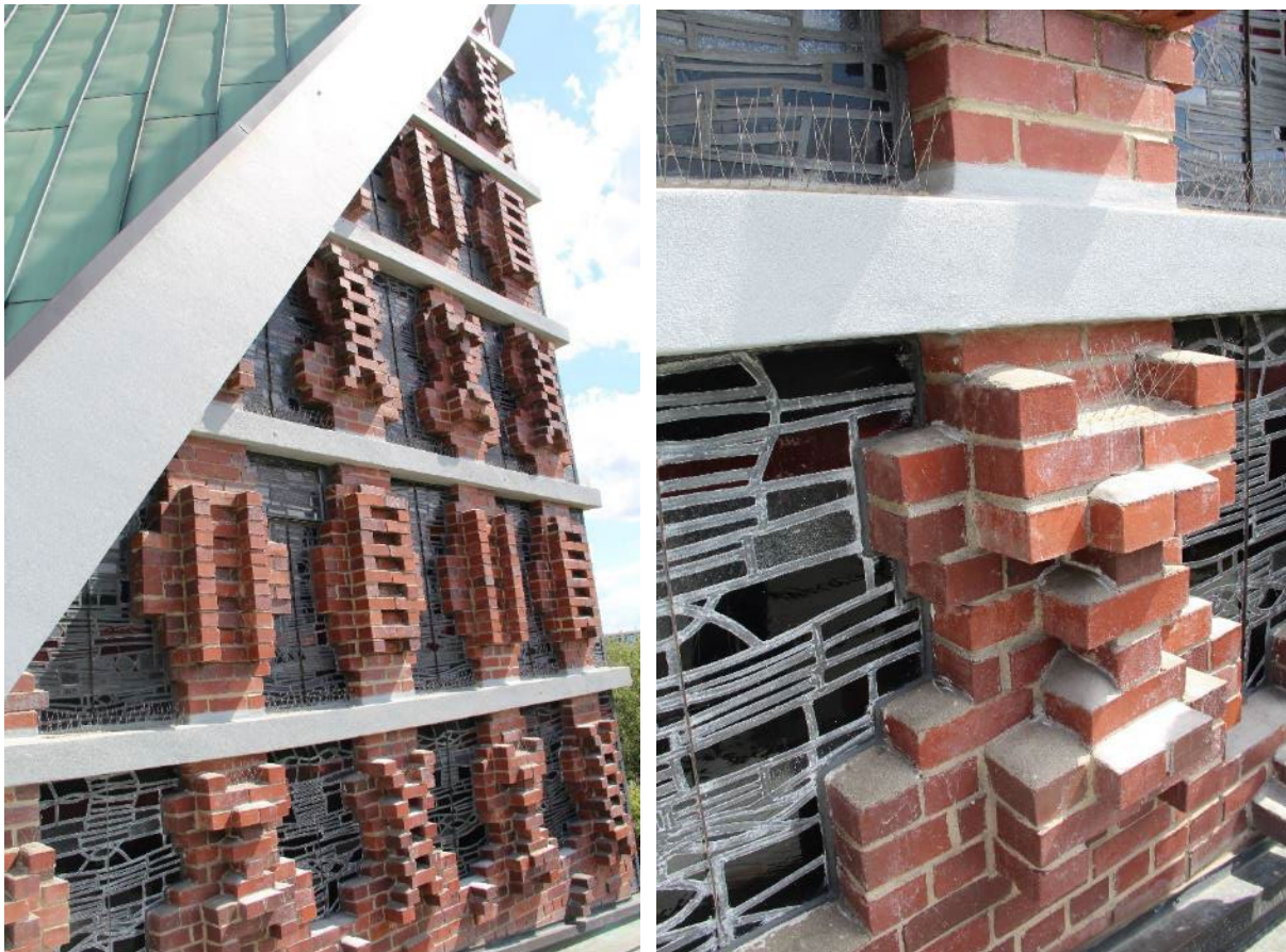
Abb. 9: Links: Abschnitt der aus einer Kombination aus Buntglasfenstern und Mauerwerk gefertigten Fassade im Zeltdachbereich. Rechts: Detailaufnahme zeigt die Ausführung einer ersten Sanierungsmaßnahme, bei der die Oberseite der freiliegenden Ziegelbereiche händisch abgedichtet werden musste, da Lochziegel anstatt planmäßig vorgesehener Vollziegel verwendet wurden.
