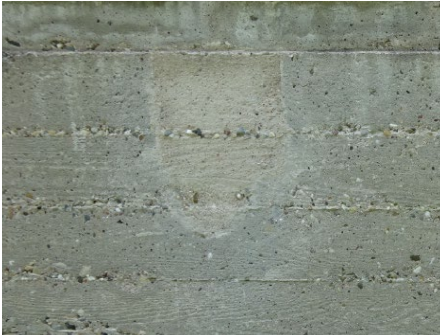
Abb. 30: Einarbeiten von Kieselsteinen in die Reparaturflächen zur Nachstellung der teilweise durch Bindemittelgrate, teilweise durch freiliegende Kieselsteine vorgezeichneten Schalbrettstruktur.
