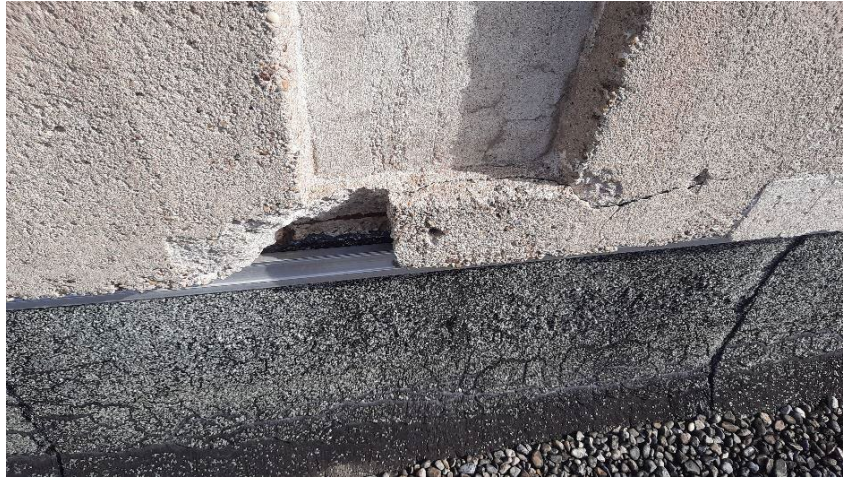
Abb. 59: Oben (Überblickfoto): Fehlstelle im Bestandsbeton über dem Dachanschluss. Unten (Detailfoto): Die Ablösung infolge Bewehrungskorrosion ist bereits weiter nach rechts fortgeschritten. Die am rechten Bildrand anschließende hellere Reparaturstelle ist jedoch intakt.
