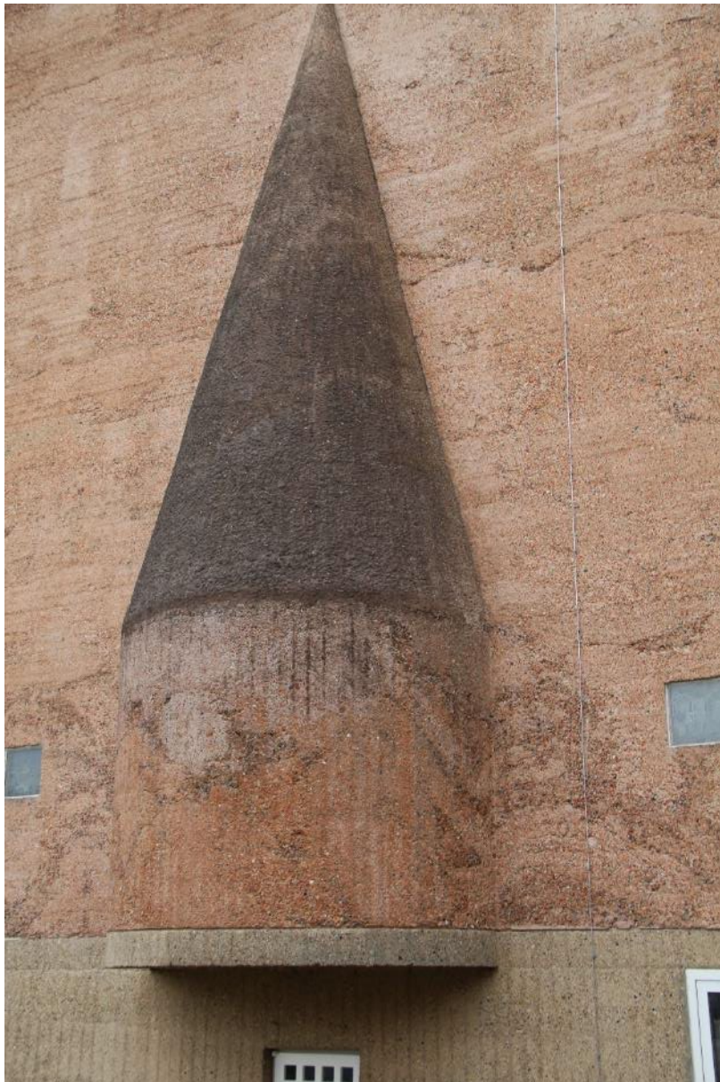
Abb. 40: Dunkle Verfärbung der Instandsetzung (Spritzbeton auf Kegel)
