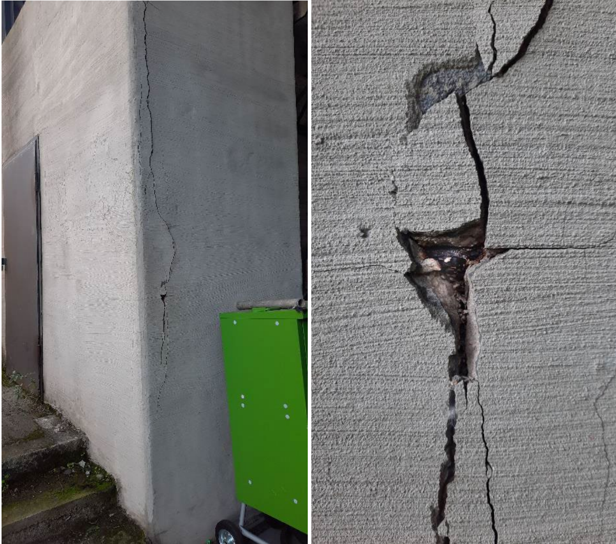
Abb. 53: Links: Riss in einer konventionell instandgesetzten Fläche des Kohlenbunkers, Rechts. Detail mit Blattrost auf der Bewehrung.
