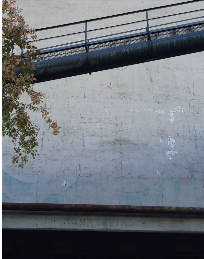
Abb. 54: Das überwiegend orthogonal ausgebildete Rissmuster am Kohlenbunker scheint die Lage der Bewehrung nachzuzeichnen.
