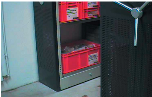
Abb. 9 und Abb. 10: Foto und Thermokameraaufnahme eines außenwandseitig montierten Regals; Klimaanlage in Betrieb (März): oben 15 °C; Boden 13,2 °C; Sockel 13,5 °C, Außenwand unten 13,6 °C; Kiste 14,5 °C. Die Kisten kühlen zum kalten Boden auf dem wärmeleitenden Metallsockel und zur Wand hin aus. Der Temperaturunterschied beträgt 1,5 °C zur zweiten Regaletage (Fotos G. Krüger).
