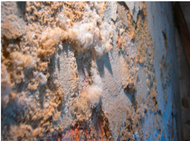
Abb. 18: Ausgeblühte Salze auf Putz ( https://commons.wikimedia.org/wiki/File:Ausbl%C3%BChungen.JPG ) (Foto: Mateus2019).
