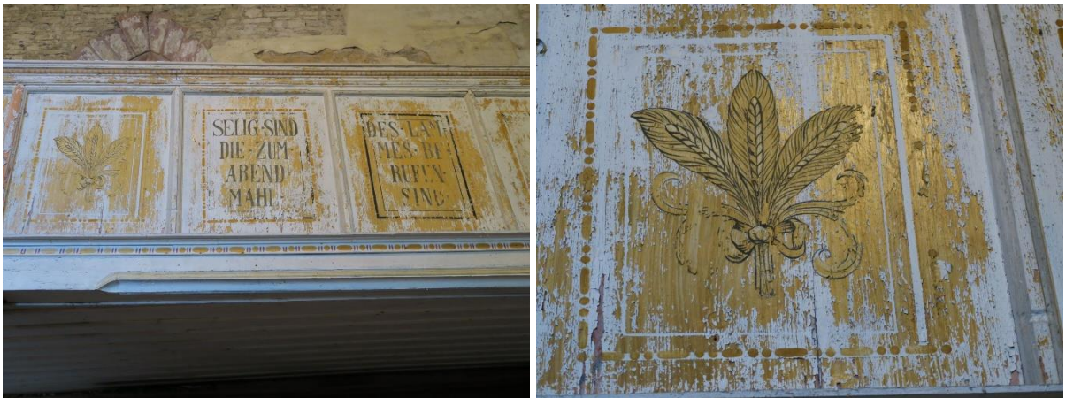
Abb. 6: Lockerungen und Substanzverluste in gefassten Holzvertäfelungen der Emporen. (Fotos: 21.01.2019, Karoline Danz).
