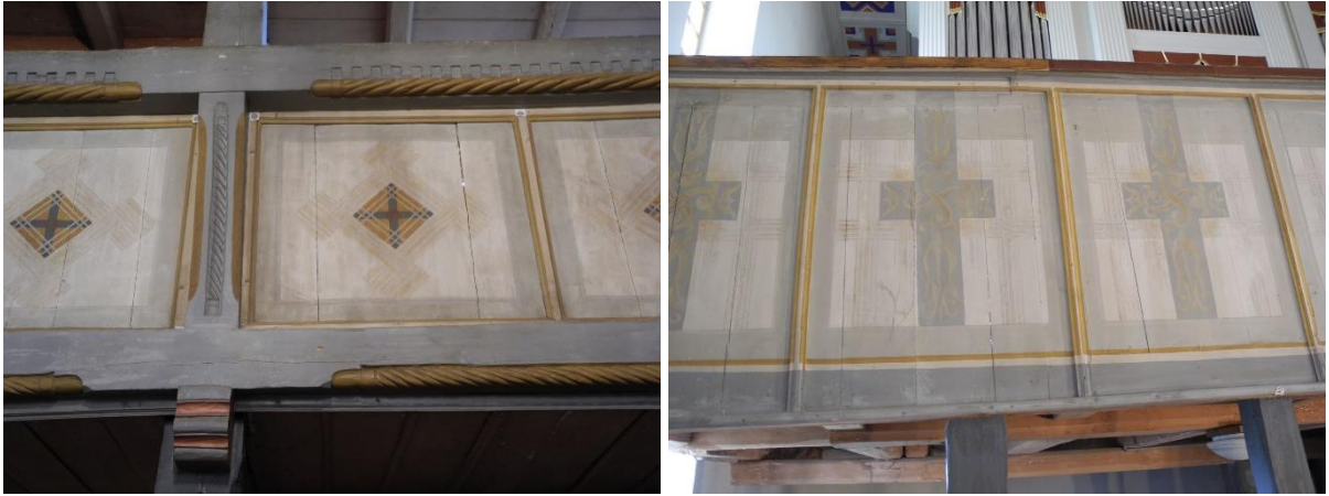
Abb. 5: Risse in den Holzvertäfelungen an der Nordseite (links) und der Westseite (rechts), (Fotos 7.10.2020, Karoline Danz).
