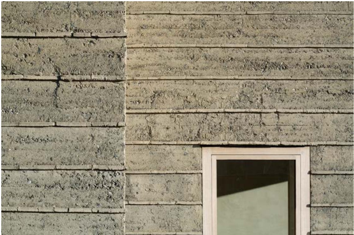
Abb. 57 Die dem Wetter exponierte Fassade des Haus Rauch kurz nach Fertigstellung 2008. Mit freundlicher Genehmigung von Martin Rauch
