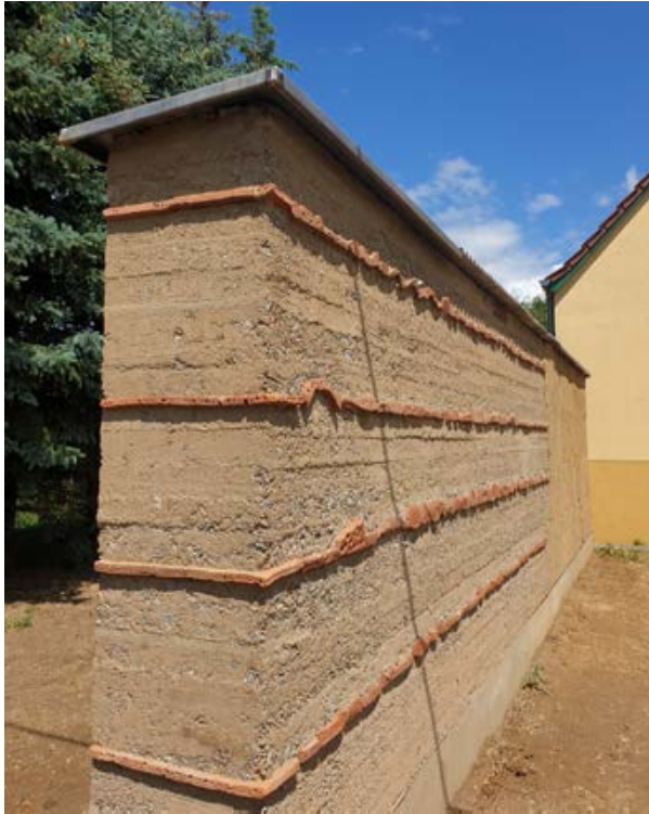
Abb. 41 Die fertige Probewand; im Vordergrund der Stampflehmabschnitt mit Schichten von gelochten 'Bienensteinen' aus gebranntem Ton, die gleichzeitig auch als 'Erosionsbremsen' gegen herablaufendes Regenwasser dienen. Foto Ute Reeh
