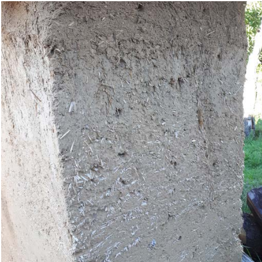
Abb. 60 Abgestochene Wellerlehmoberfläche auf der Wetterseite nach zwei Jahren. Foto Christian Hansel
