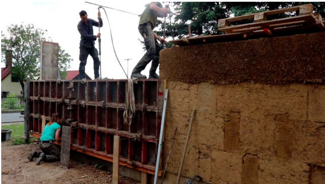
Abb. 39 Stampfen einer neuen Schicht Stampflehm in der Verschalung mittels pneumatischer Verdichtern (Videostandbild Daniel Beltrán)
