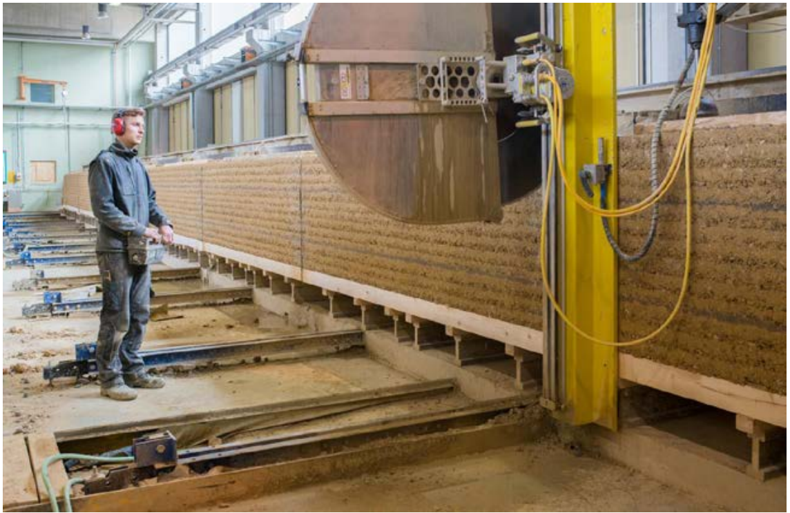
Abb. 18 Zuschnitt der vorgefertigten Stampflehmwand auf Elementlänge mittels Groß-Kreissäge. Foto Emmanuel Dorsaz / Lehm Ton Erde Baukunst GmbH
