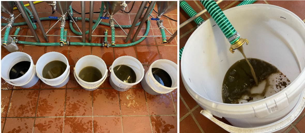
Abbildung 8-5: Schlammabzug Absetzanlage; links: 5 Schlammproben nach dem Abzug; rechts: Schlammabzug.
