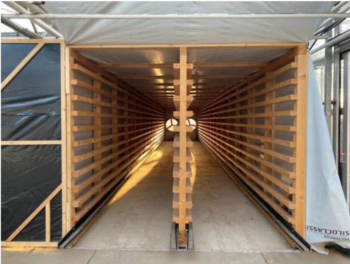
Abbildung 9: Blick in die Trockentunnel mit Ventilator
