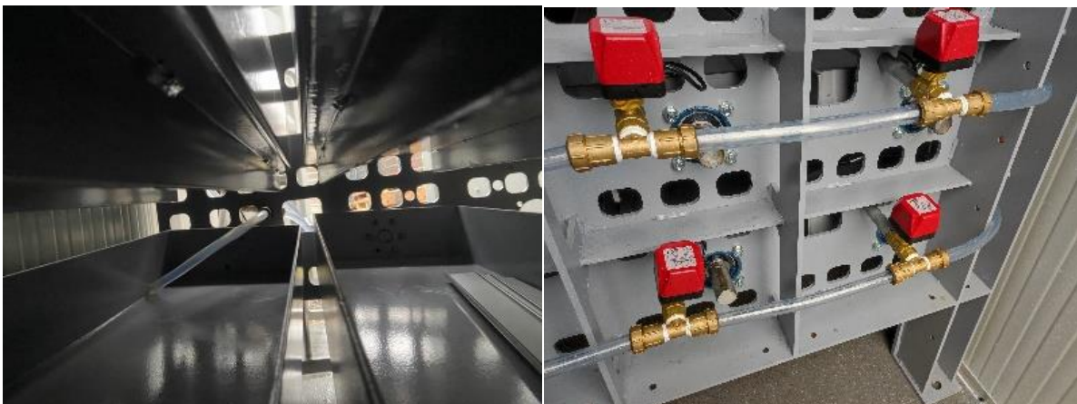
Abbildung 5: Drehbar gelagerte Mastwannen mit stirnseitiger Belüftung und Flüssigfütterung in die Mastwannen mittels computergesteuerter Ventile
