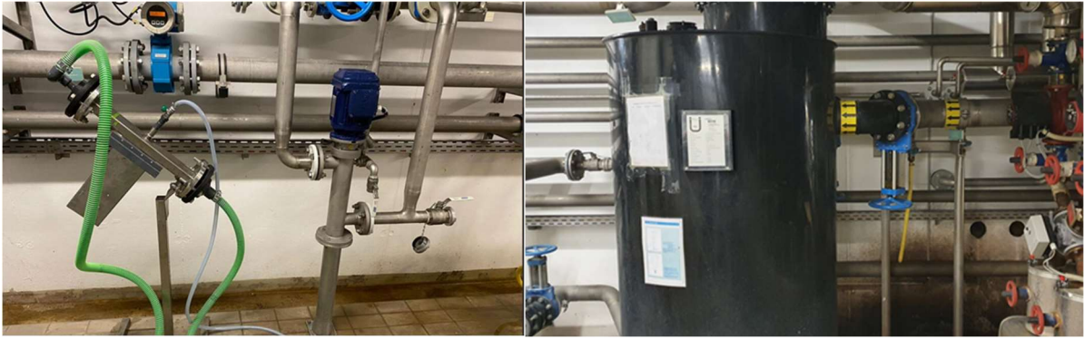
Abbildung 4 Zentratsensor (links) und Zentratbehälter KA Wolfenbüttel (rechts)
