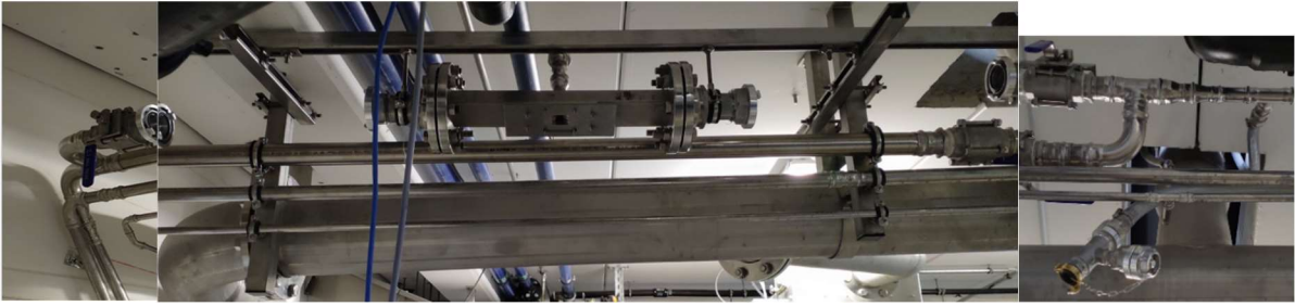
Abbildung 9 Zentralkontrollleitungsabschnitt mit Bypass und Küvettenaufhängung
