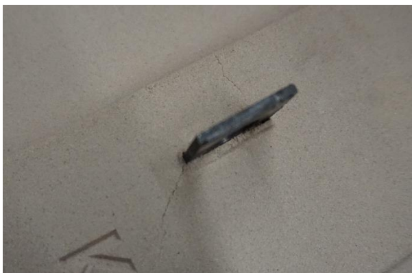
Abbildung 15-33: a) Risse an Aufhängeöse
