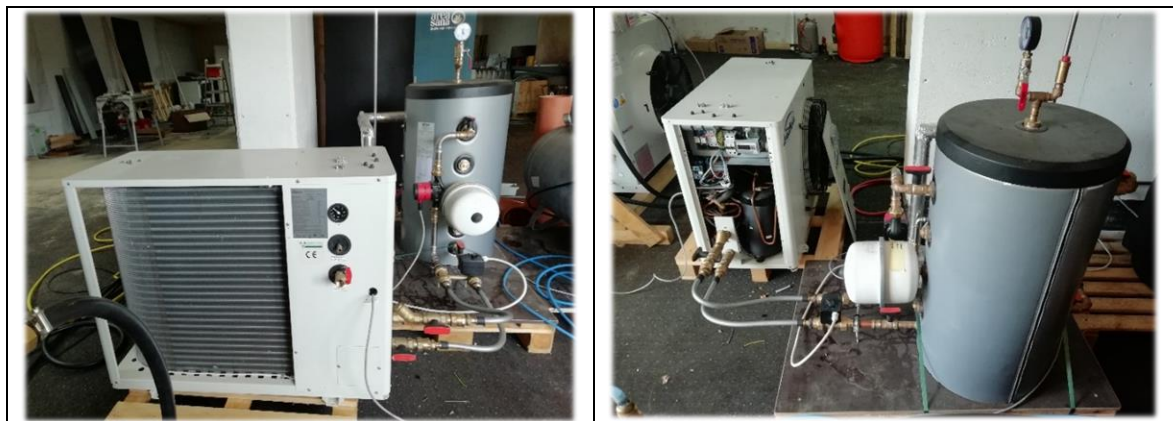
Abbildung 17: Kaltwassersatz (Wärmepumpe) mit Mischer und Zwischenspeicher
