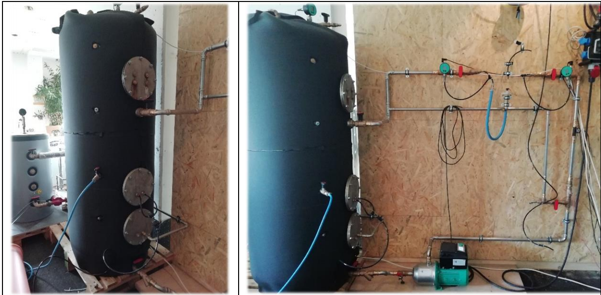
Abbildung 16: Tank, Sensorik und Umwälzung
