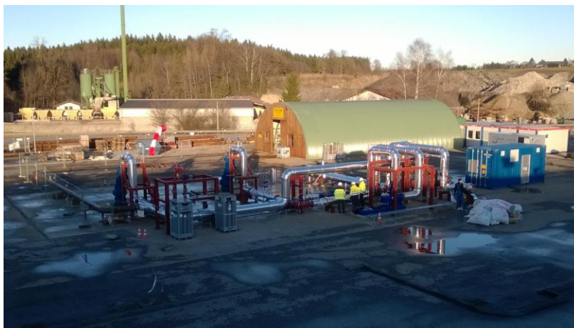
Abbildung 1: Geothermieranlage Traunreut [ https://www.geothermie-traunreut.de/fotos-neu/ ]
