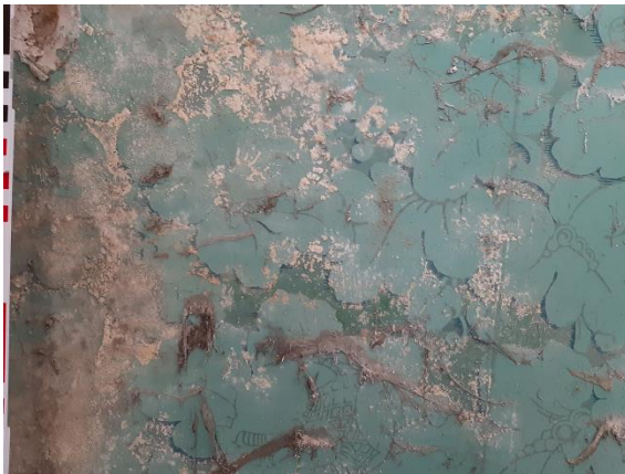
Abb. 20 An den Außenwänden Hinweise auf starke Belastung mit Schimmelpilzen
