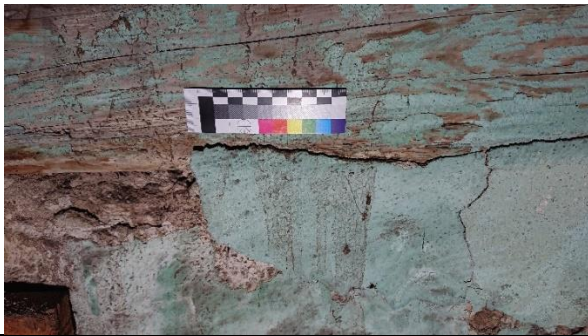
Abb. 1: Probennahmestelle. Mehrere Farbschichten auf Holz und Putz. (L. Lenninghaus 2022)
