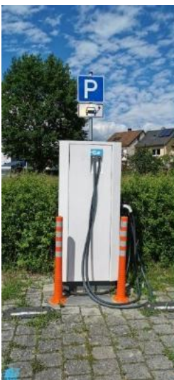
Abbildung 10 Schnellladesation 3 Ladepunkte 50kW 800V
