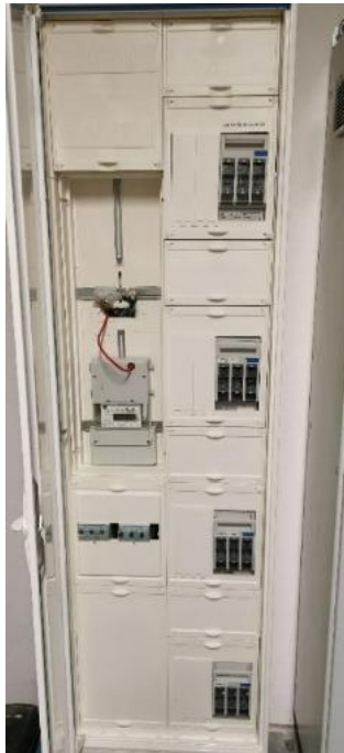
Abbildung 8 Verteil- und Zählerschrank
