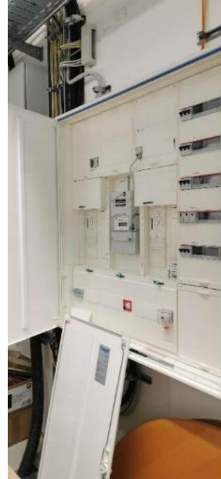
Abbildung 6 Unterverteilung und PV Zähler
