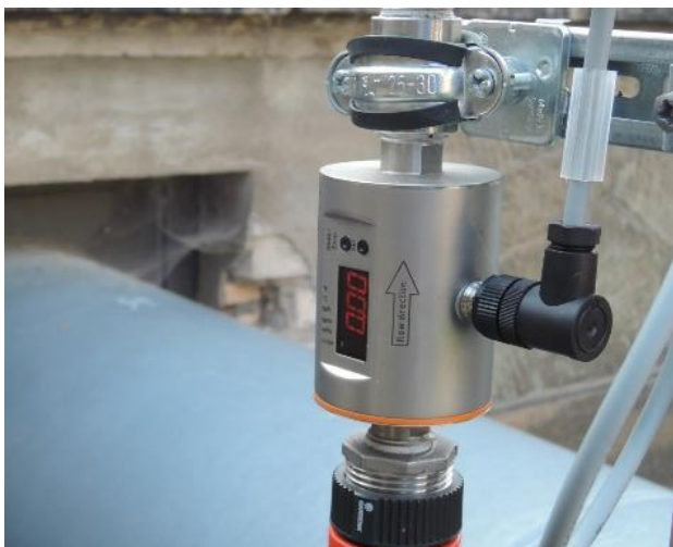
Abbildung 2.3-2: Durchflussmesser am Dachzulauf.
