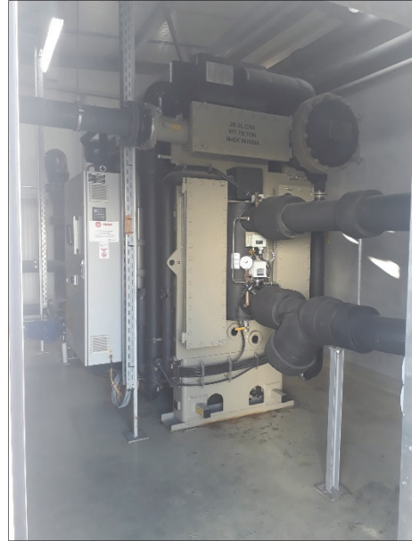
Abbildung 11: Absorptionskältemaschine (Quelle: Vowalon Beschichtung GmbH)
