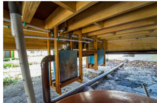
Abbildung 35: Entwässerungsinfrastruktur unter dem Gebäude (Quelle: Fairventures)
