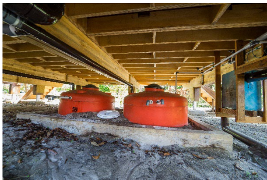
Abbildung 34: Wassertanks unter dem Gebäude (Quelle: Fairventures)
