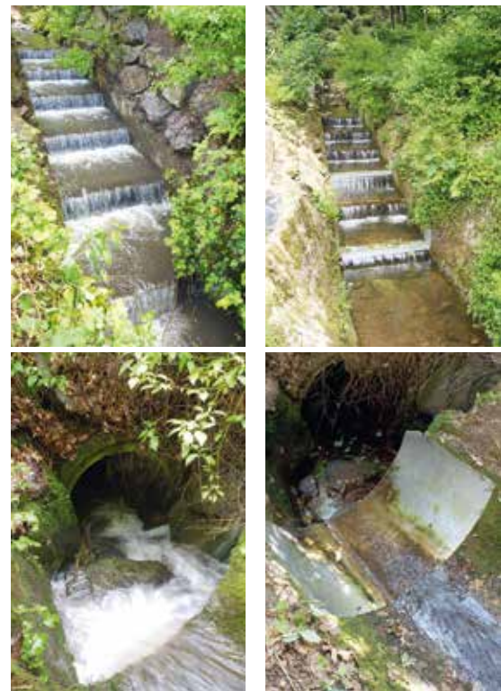
Abb. 10: Zwei hintereinander geschaltete Varianten von Krebschutzblechen im Zieggraben (Abstürze vorher = links und nachher = rechts)
