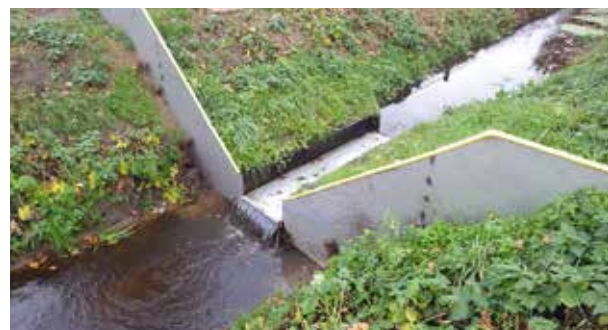
Abb. 4: Sperre im Seitenarm
