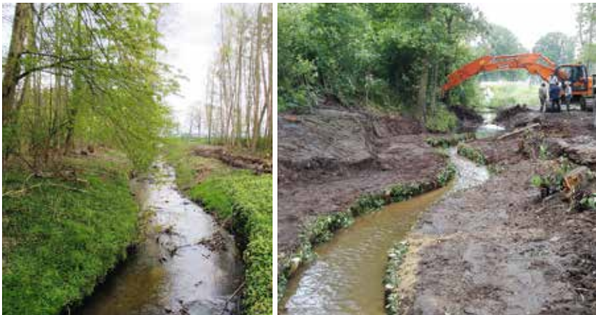
Abb. 2: Einengung des Gewässerprofils durch den Einbau von Faschinen und einem Kies-/Lehmgemisch im Schierenbach, Landkreis Vechta
