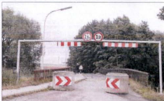
Für Fahrzeuge gesperrt: Die Fischerbrücke zwischen Leiferde und Stöckheim muss instand gesetzt werden. Foto: T.A.
