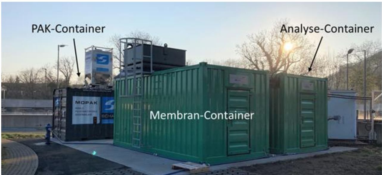
Abbildung 1: Versuchsanlage zur Phosphat-, Spurenstoff- und Keimreduktion
