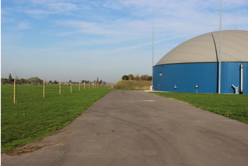
Abbildung 14: Gasspeicher (rechts im Bild) und linker Hand Druckerhöhungsstation (nicht im Bild); (Blickrichtung Nord-Westen)
