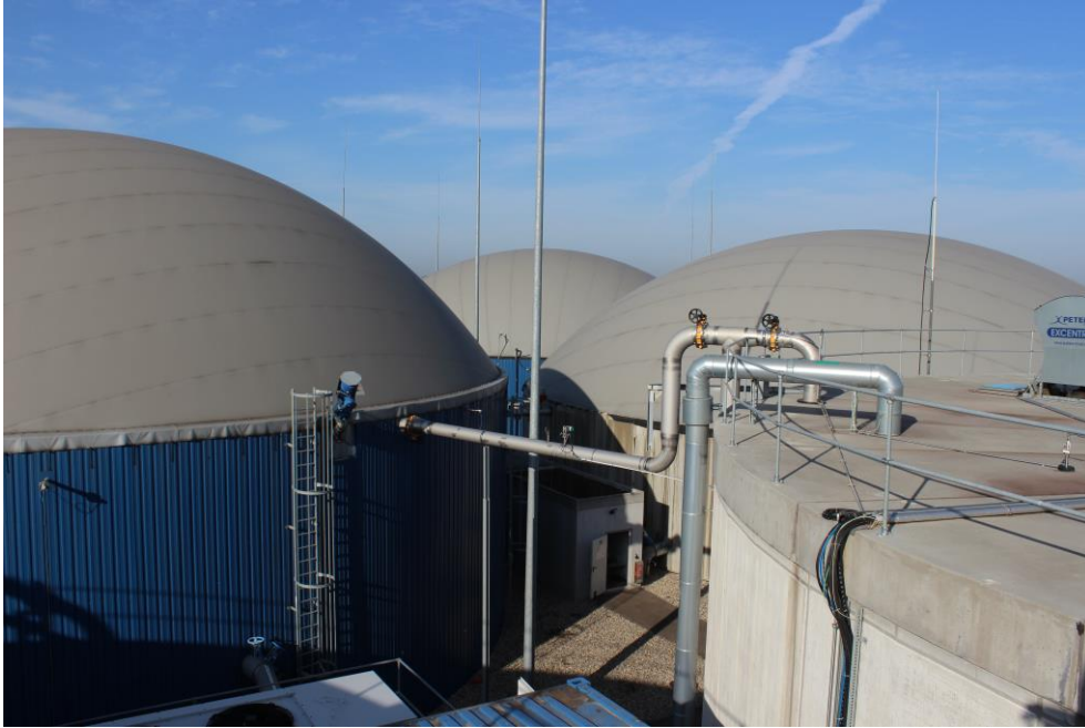
Abbildung 9: Gasspeicher und Fermenter
