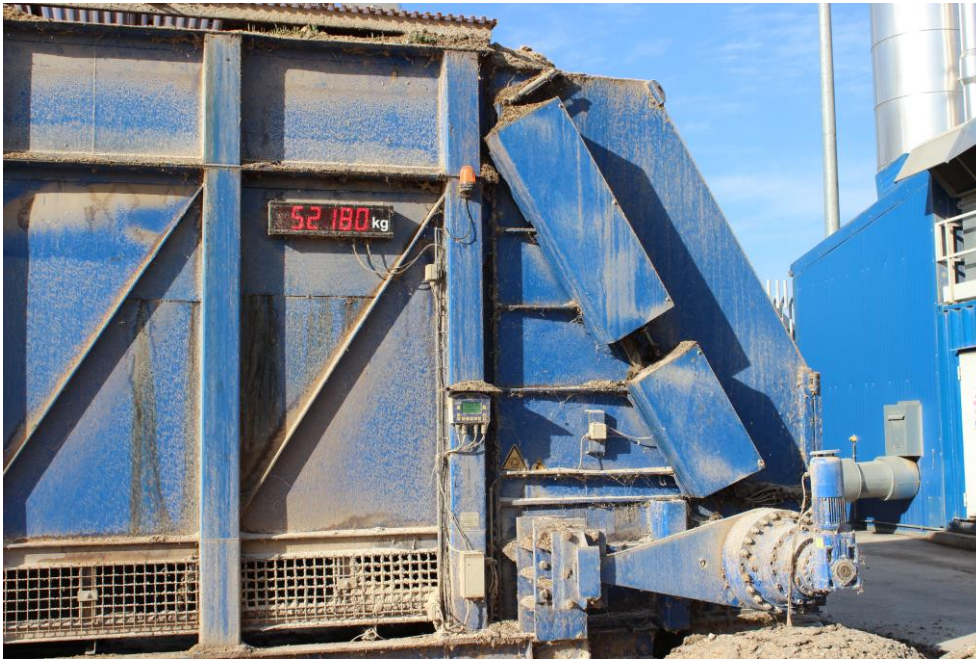
Abbildung 5: Massegesteuerte Befüllung der Fermenter mittels Förderschnecken
