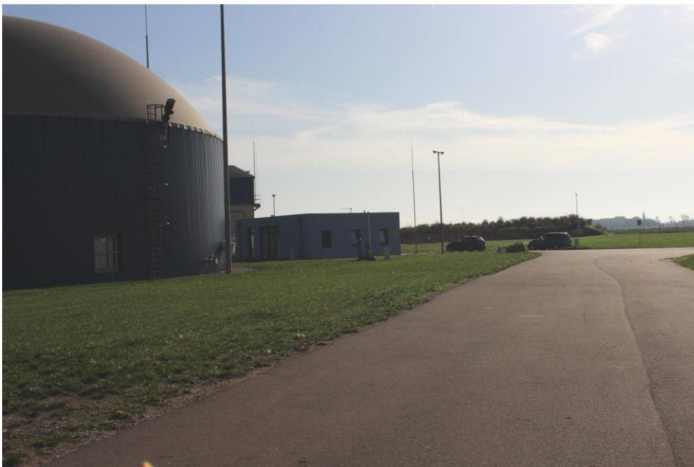
Abbildung 15: Gasspeicher (rechts im Bild) und in der Mitte die Schaltwarte (Blickrichtung Süd-Westen)
