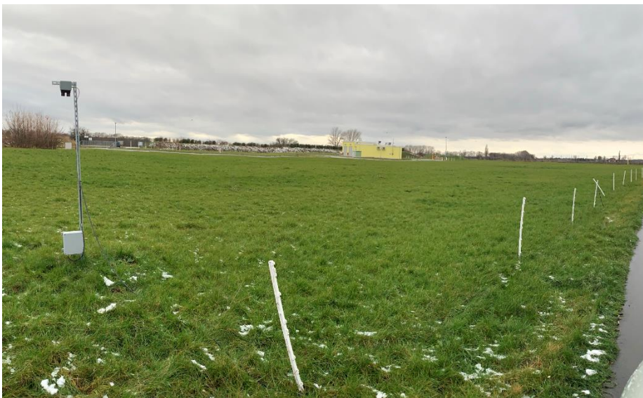
Abbildung 8: Sensor 3 mit Kabelführung per Weidepfosten
