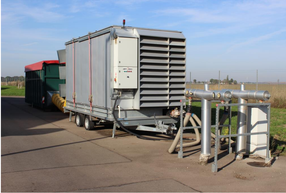
Abbildung 11: Nutzung überschüssige Wärme zur Brennholztrocknung (Verweildauer des Holz ca. 14 Tage)
