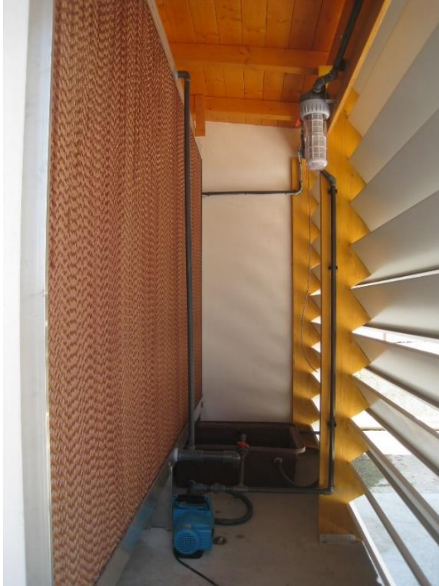
Abbildung 5: Coolpad-System (links) mit Lamellenwand (rechts), Pumpe und Auffangwanne
