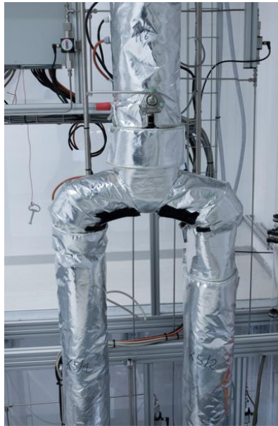
Abbildung 5) Y-Stück an der realen Anlage.
