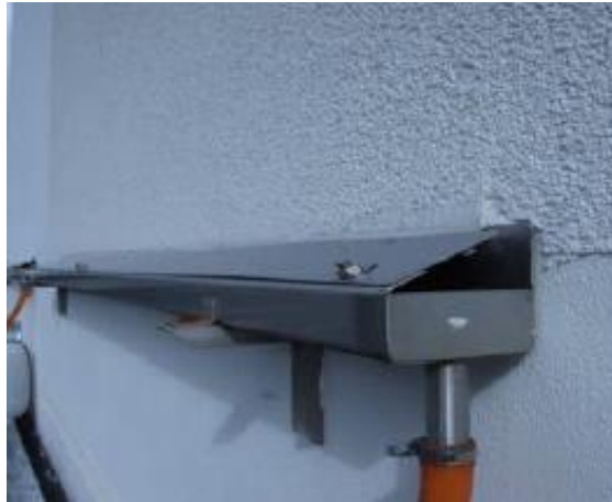
Abbildung 26: Fassadenrinne für Probefläche 1 – 4 der Fassadenuntersuchungen.
