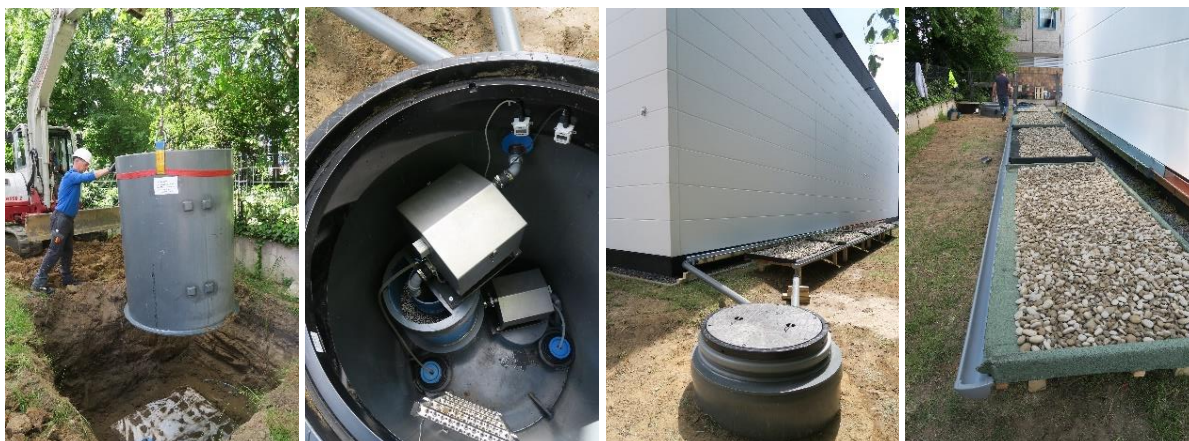
Abbildung 14: Pilotinstallation des Regenfilters, an den 150 m 2 Fassadenfläche mit Abflusssrinnen aus Zink und Kupfer, zwei Testflächen mit Bitumenbahnen sowie zwei Testflächen mit EPDM-Bahnen angeschlossen sind.
