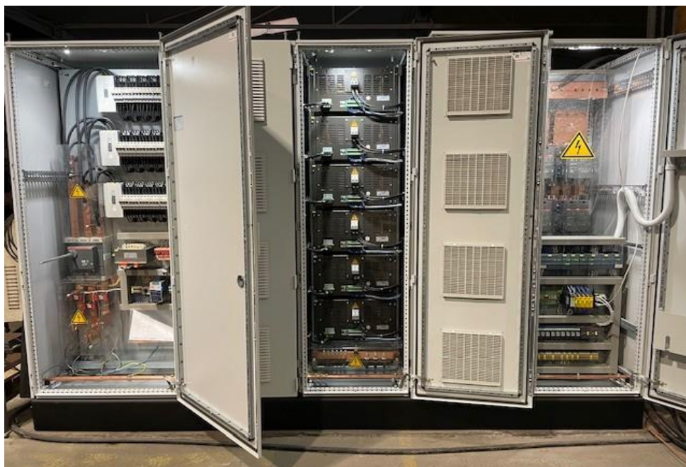
Bild 16 – Schaltschrankaufbau der Stromversorgung
