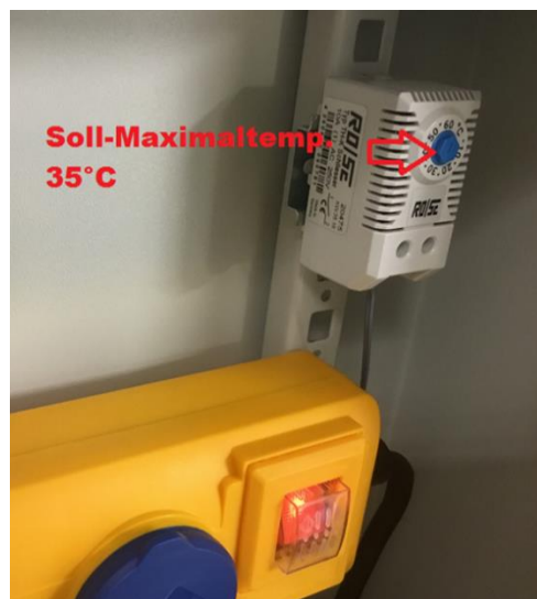
Temperaturüberwachung im Dosierschrank, Bild 16
