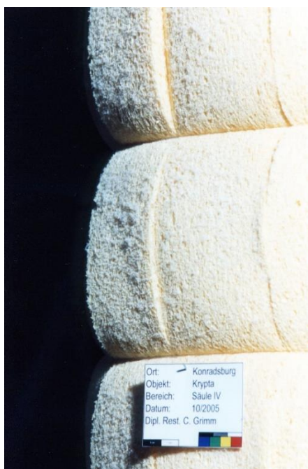
Abb. 48: Detail einer Kompressenauflage während der Trocknung mit sichtbaren Effloreszenzen.
