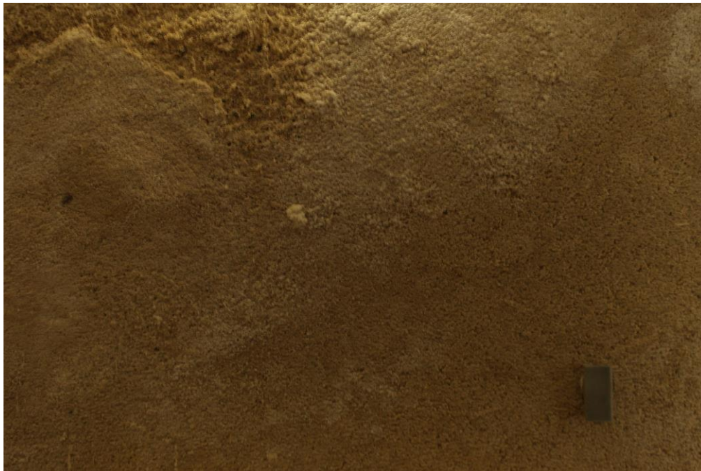
Abb. 54: Ermsleben, Konradsburg, Krypta: salzbelasteter Putz (Westwand, Mitte)
