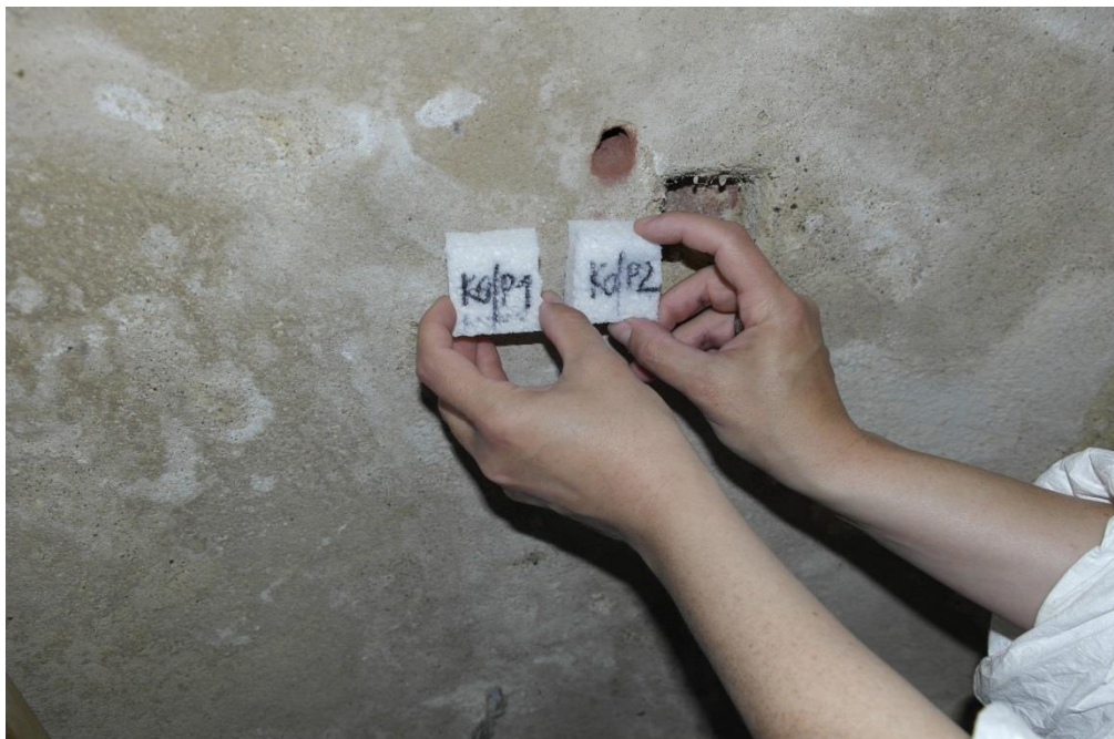
Abb. A32: Ermsleben, Konradsburg, Krypta: Schwammkompressen zur Beprobung salzbelasteter Oberflächen (Probenahmepunkt 1, Ostwand, NO-Ecke)
