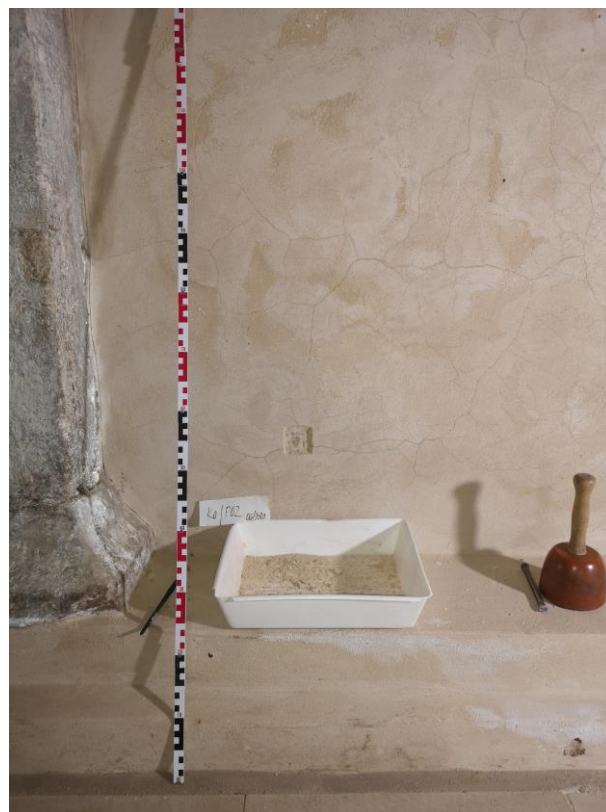
Abb. 62: Ermsleben, Konradsburg, Krypta: Probenahmepunkt 1, Ostwand, NO-Ecke
