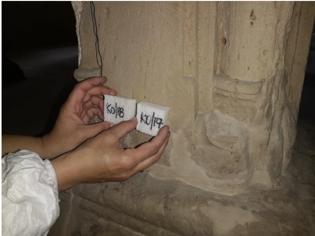
Abb. A35: Ermsleben, Konradsburg, Krypta: Schwammkompressen zur Beprobung salzbelasteter Oberflächen (Säule, Schaft)
