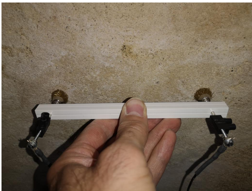
Abb. 50: Ermsleben, Konradsburg, Krypta: Messung der elektrischen Leitfähigkeit auf dem salzbelasteten Putz
