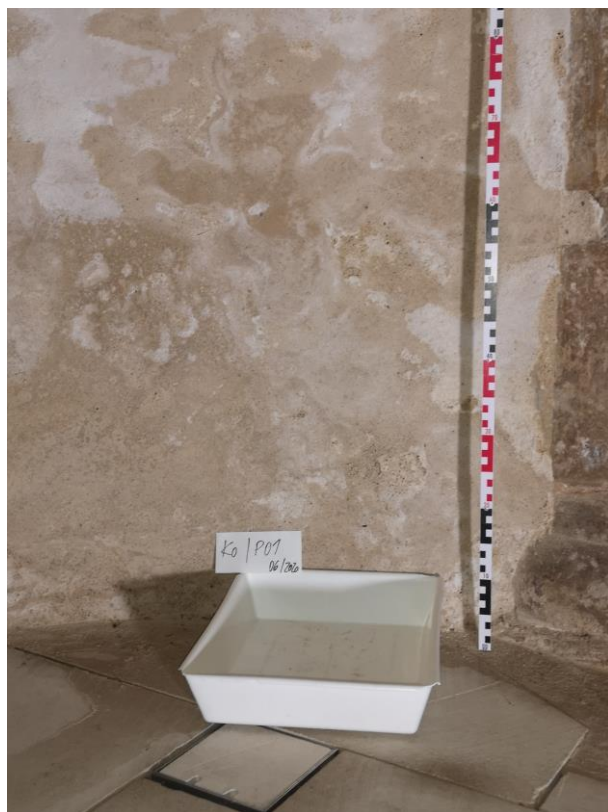
Abb. 61: Ermsleben, Konradsburg, Krypta: Probenahmepunkt 1, Ostwand, NO-Ecke
