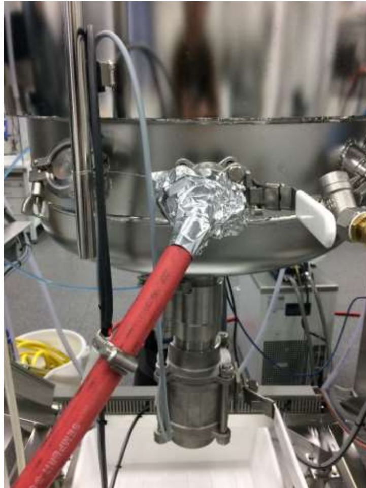
Abbildung 27: Anschluss des Dampfsterilisators über das Probenahmeventil
