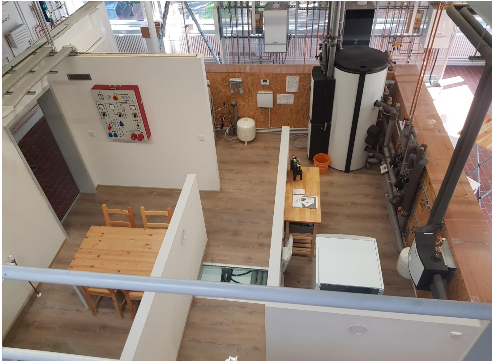
Abbildung 15 ESIH-Wohn/Esszimmer und Technikraum vom Podest aus fotografiert
