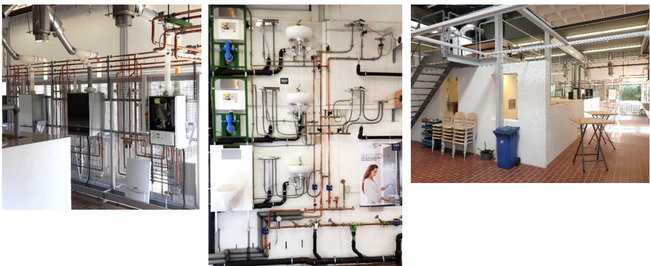
Abbildung 4 SHK-Labor mit den Trainingswänden Gas-Brennwertgeräte und Trinkwasserinstallation und dem ESIH im Zentrum (von links nach rechts)
