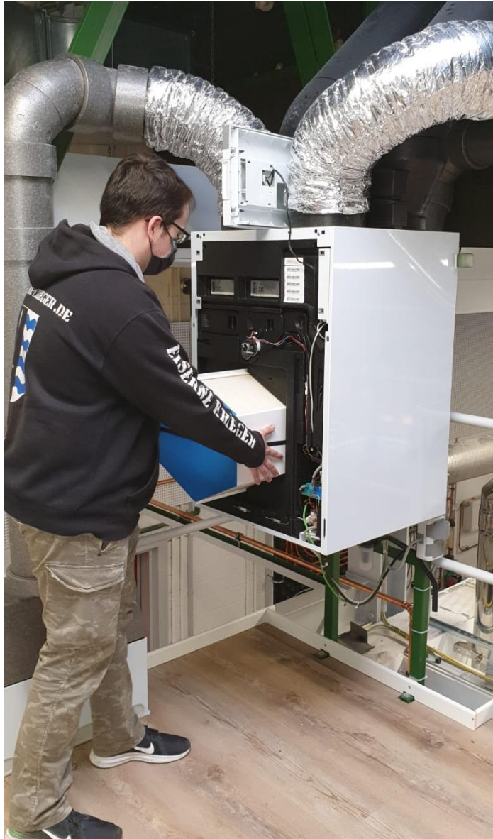
Abbildung 17 Schüler arbeitet am Zentralgerät der KWL.-Anlage
