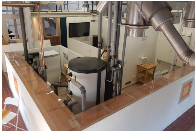
Abbildung 1 ESIH mit Technikraum im Vordergrund, Esszimmer mit Holzpellet-Ofen und Touchscreen im Hintergrund
