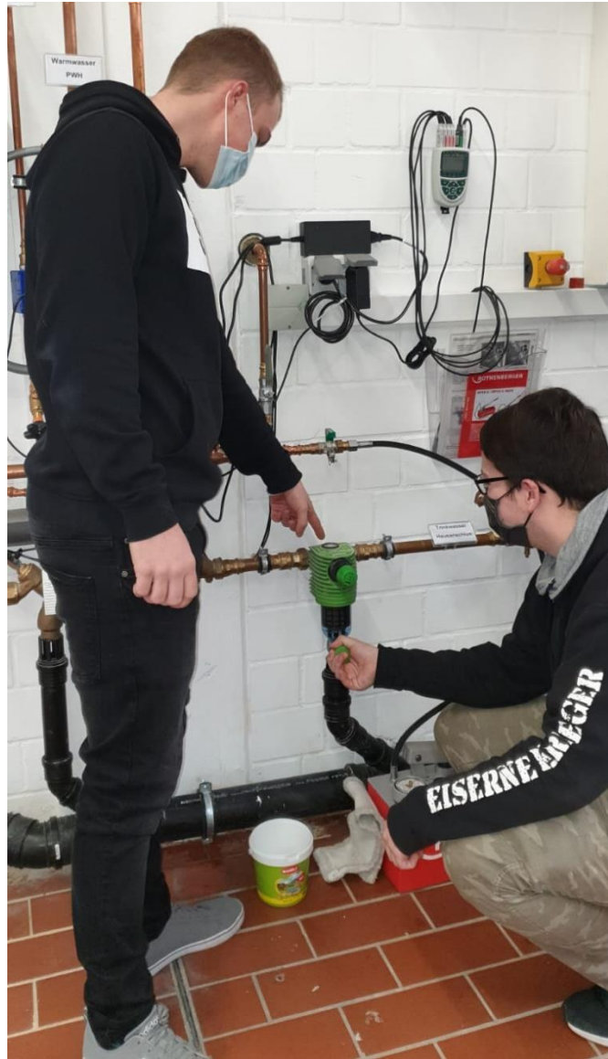
Abbildung 19 Schüler warten einen Filter an der Trainingswand Trinkwasserinstallation (unter Corona-Bedingungen)
