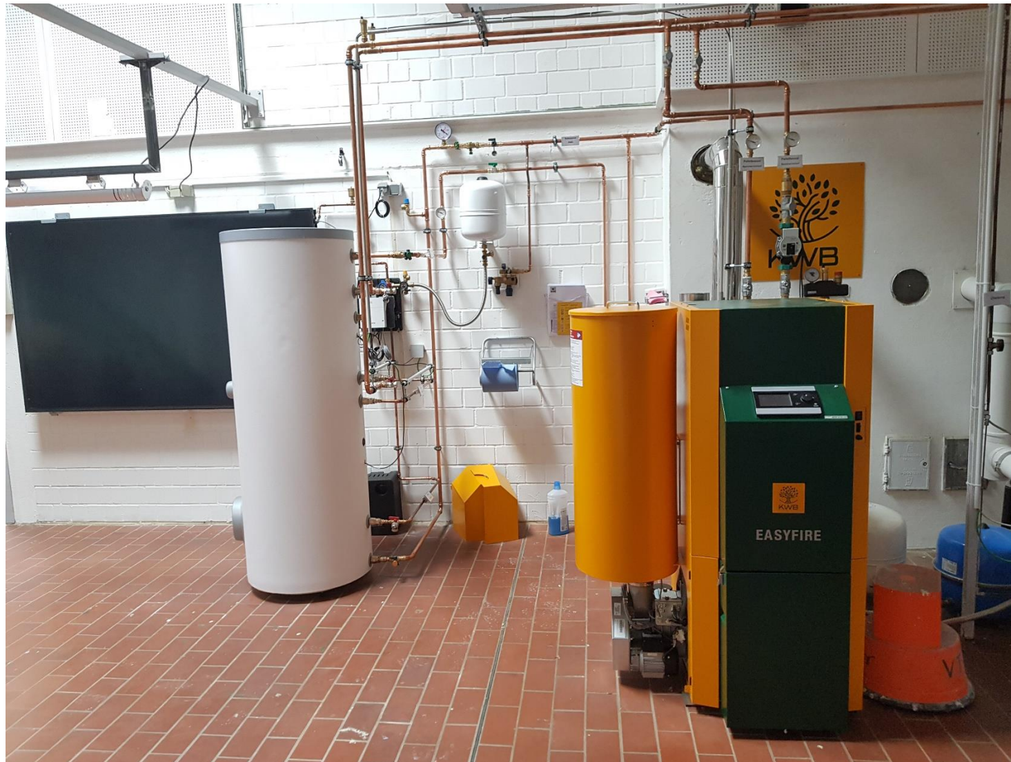
Abbildung 14 Holz-Pelletkessel mit Warmwasserspeicher und Solarkollektor
