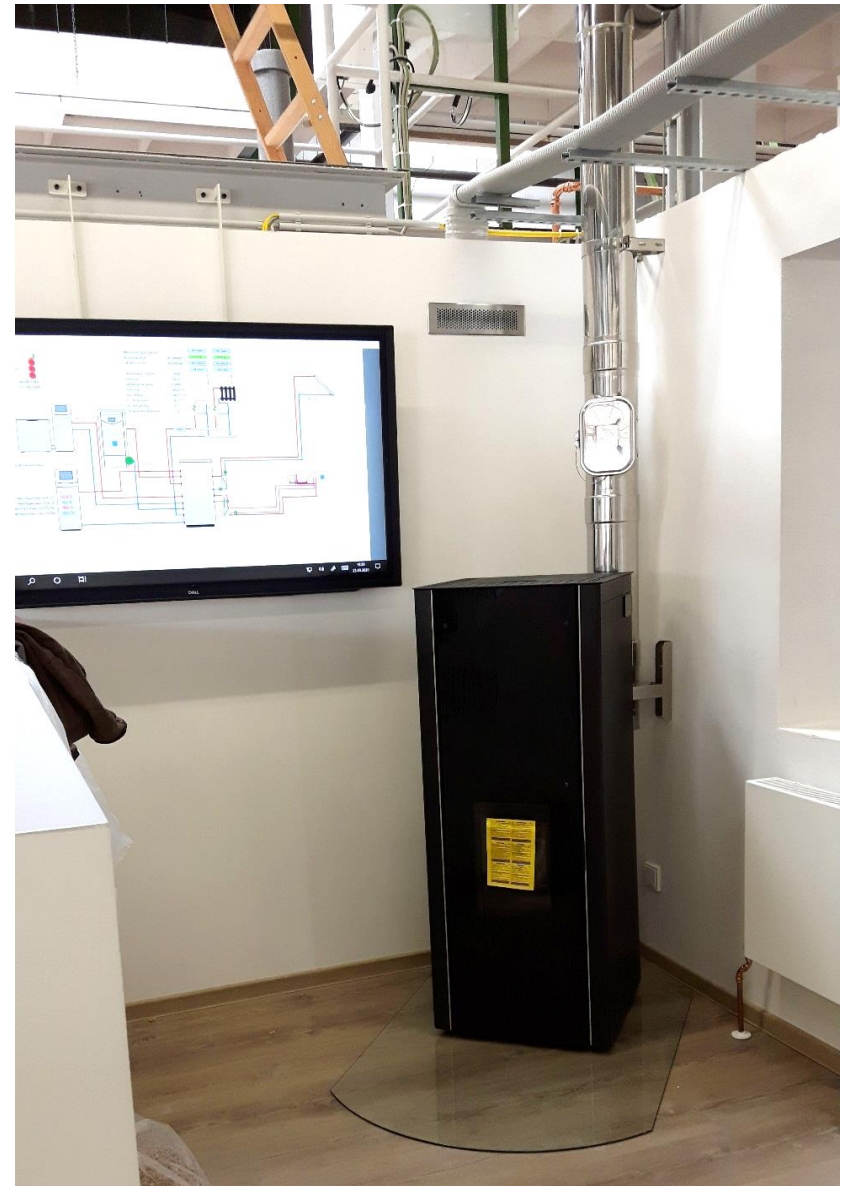
Abbildung 16 ESIH-Wohn/Esszimmer mit Monitor für Anlagenschema und Steuerung der KNX-Geräte per Touch und Pellet-Kaminofen
